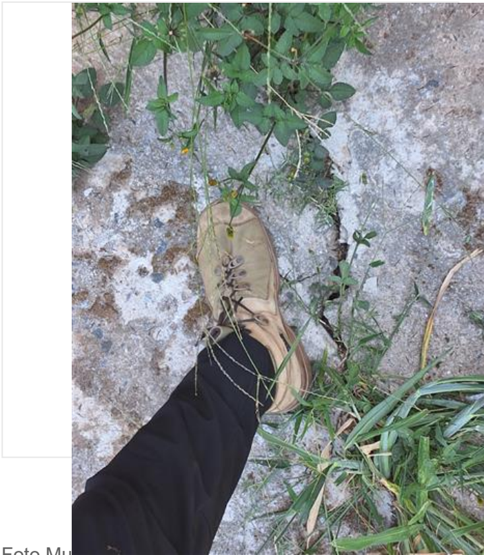
Foto Muros/ paredes abaulados
