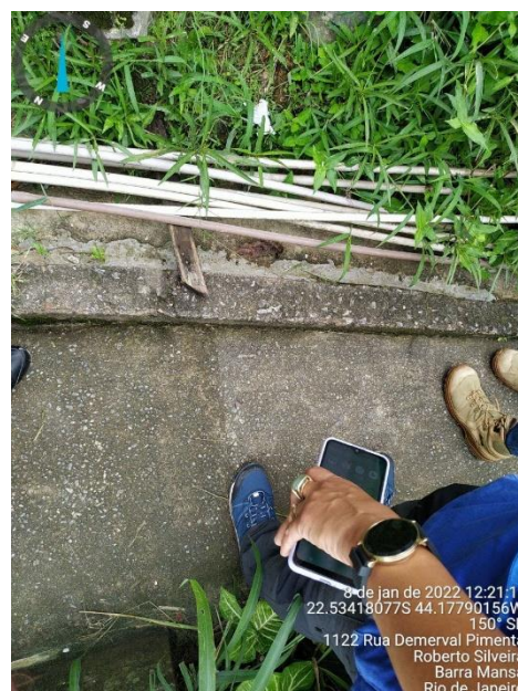
Figura 3: trincas no terreno.
