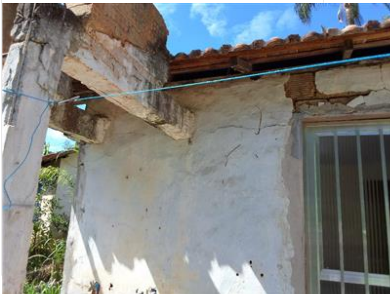
Foto Trincas no terreno
