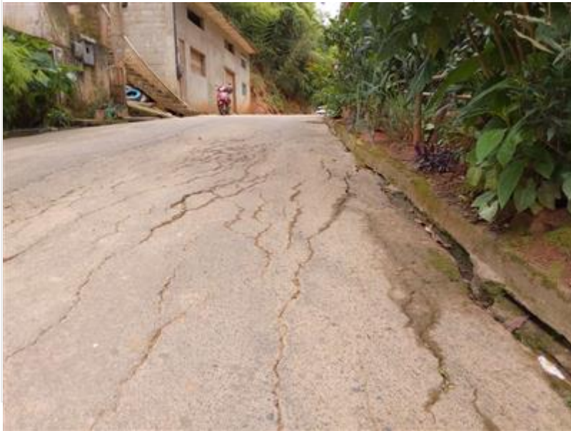
Foto Estrutura colapsada
