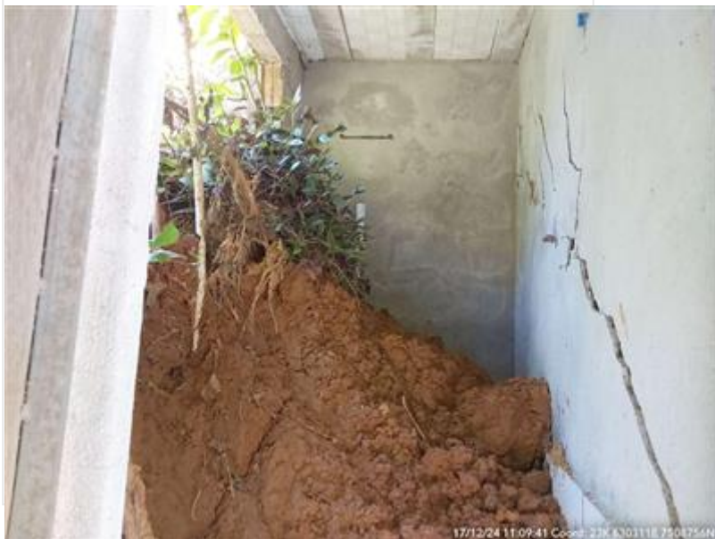
Foto Estrutura colapsada
