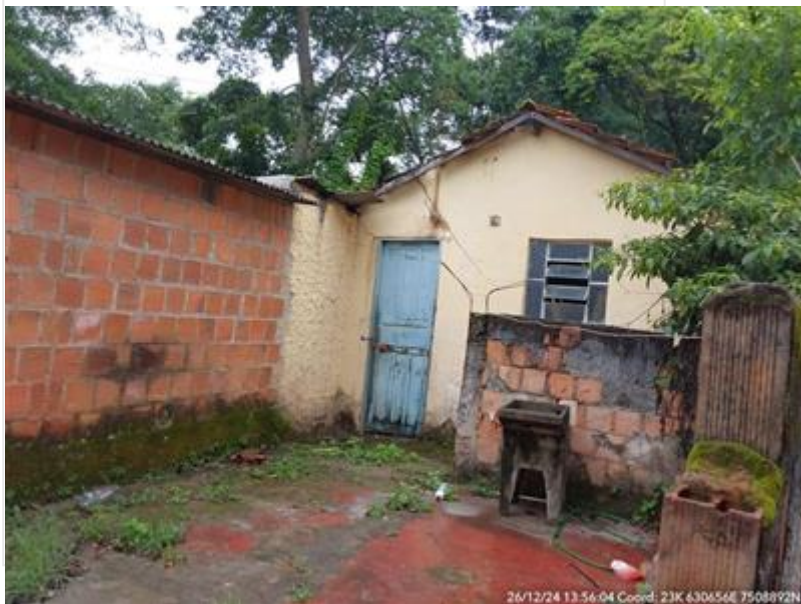
Foto Trincas no terreno
