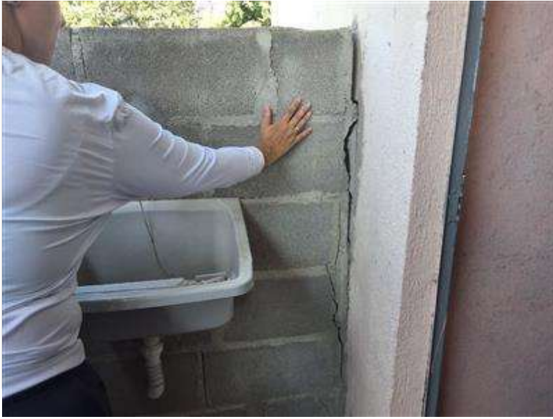
Foto Trincas no terreno
