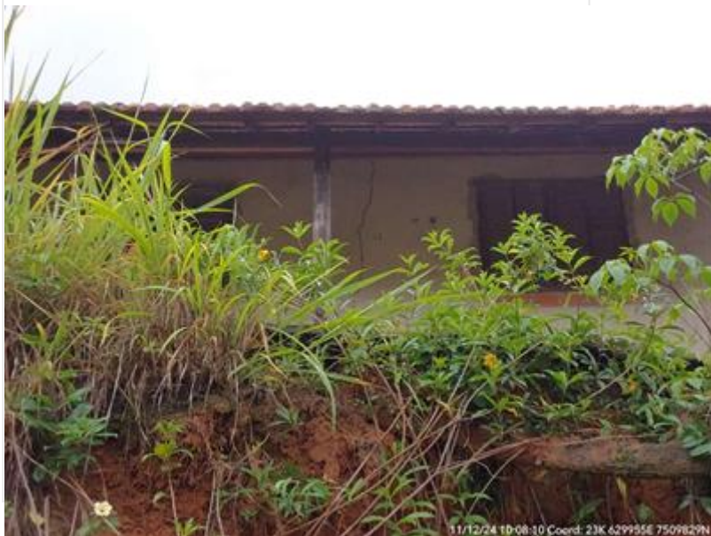
Foto Trincas no terreno
