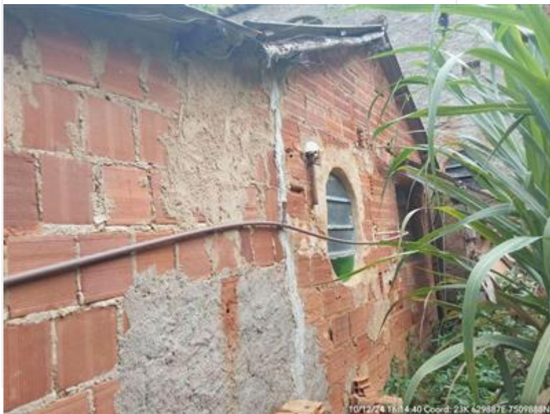
Foto Trincas em muros
