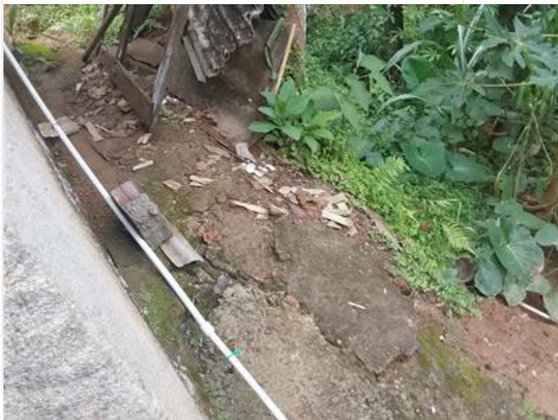
Foto Estrutura colapsada
