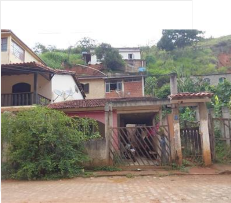
Foto Distância talude – casa
