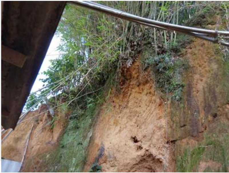
Foto Erosão Laminar
