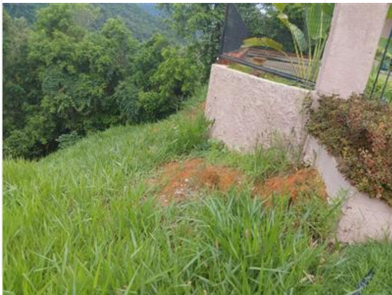
Foto Erosão Laminar
