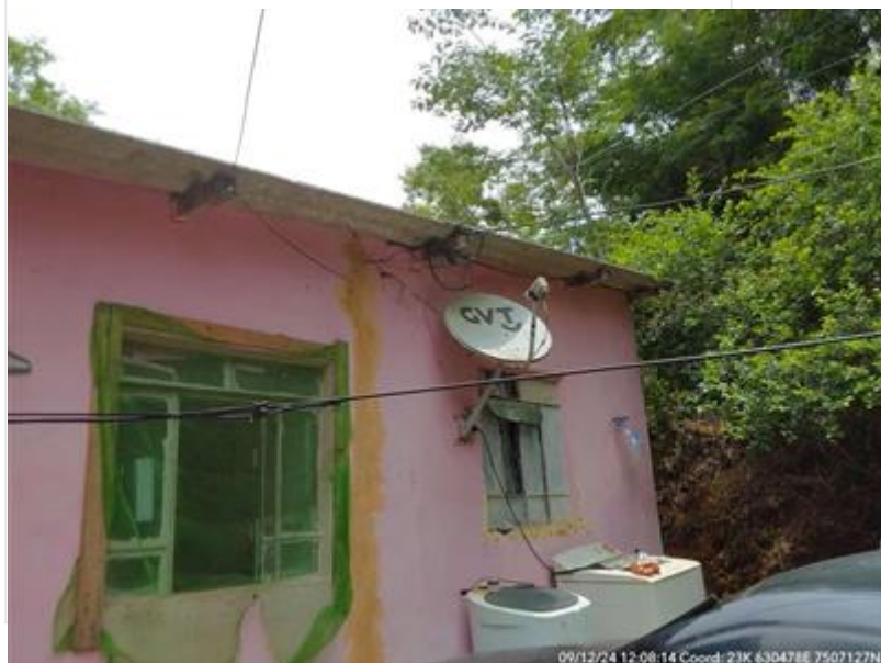
Foto Trincas no terreno
