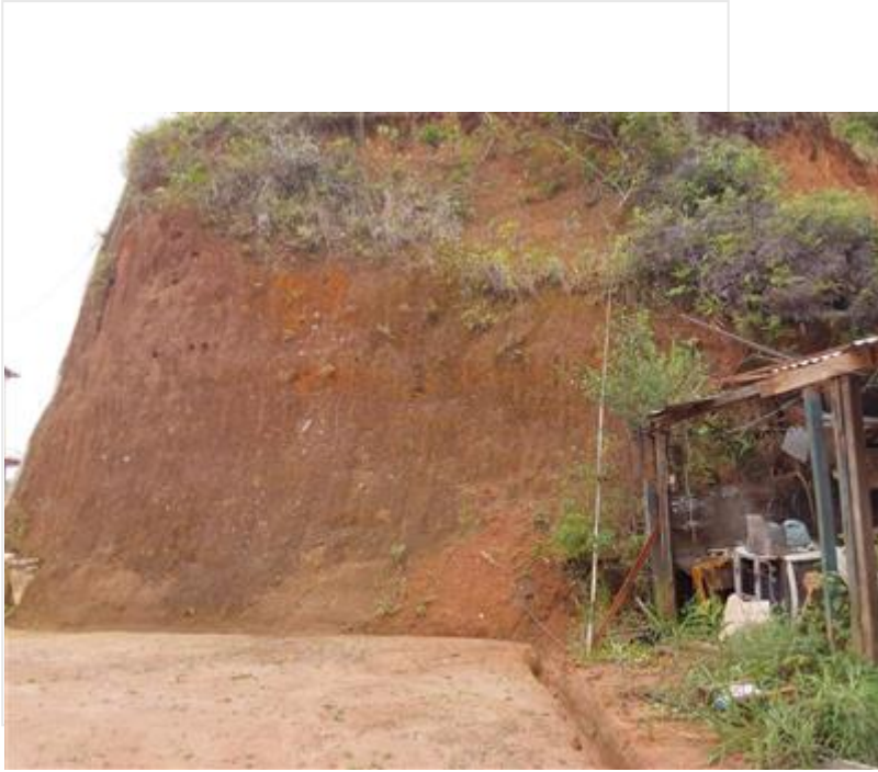
Foto Erosão Laminar
