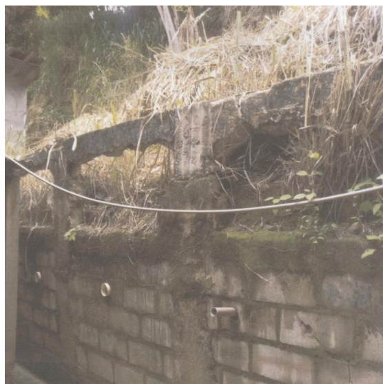
Figura 8 – Muro afetado pelo deslizamento.
