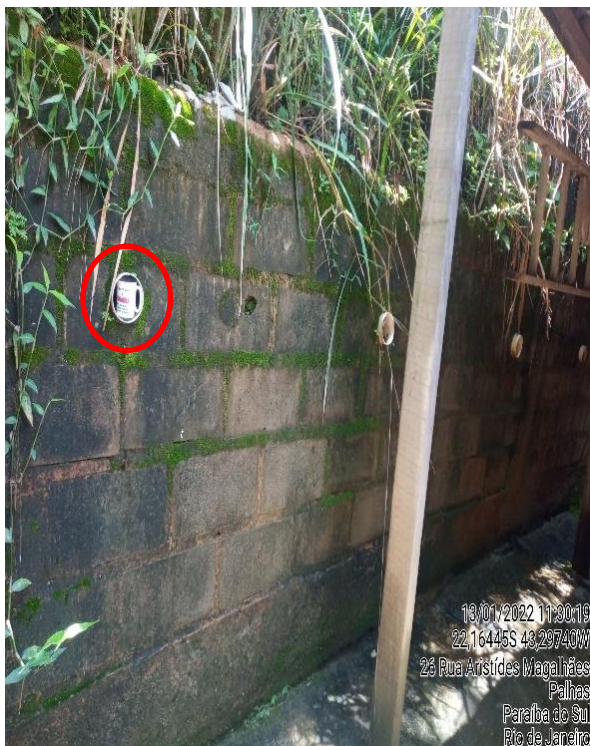
Figura 4 – Sistema de drenagem obstruído.
