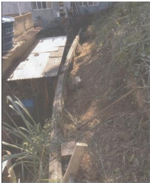
Figura 6 – Limpeza no talude sem vistoria técnica.
