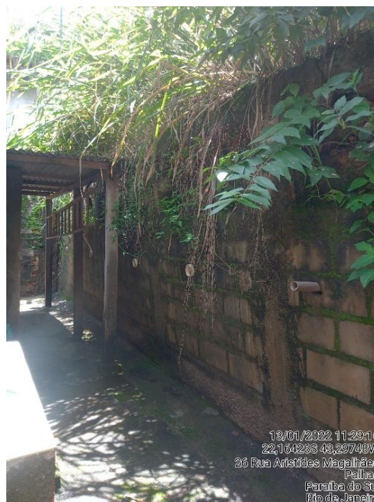
Figura 3 – Trincas e encurvadura do muro.
