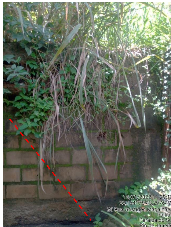
Figura 5 – Aumento das trincas no muro.
