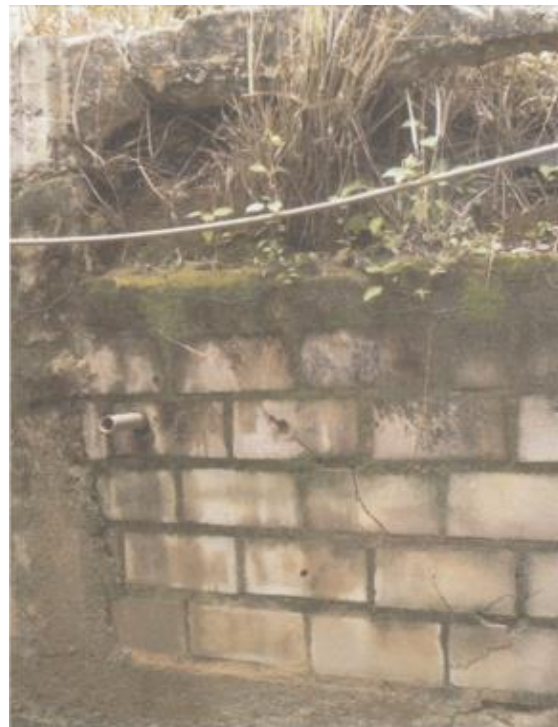
Figura 7 – Presença de trincas.
