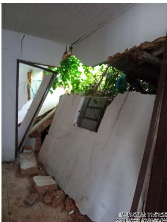
Figura 5 – Imóvel destruído pelo deslizamento.
