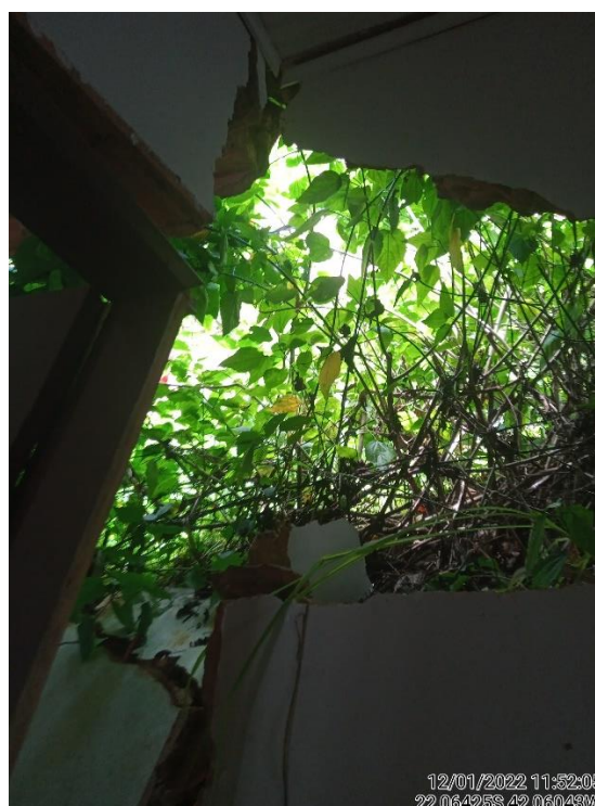
Figura 6 – Vegetação com galhos de árvores englobados no depósito do escorregamento.
