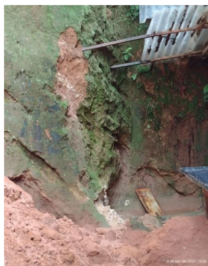
Figura 18: Orientação preservada no solo residual, favorável ao rompimento.
