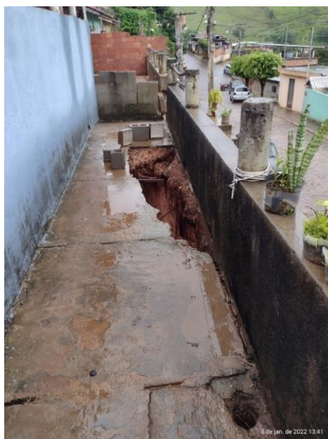
Figura 25: Parte superior do acesso, já colapsada.
