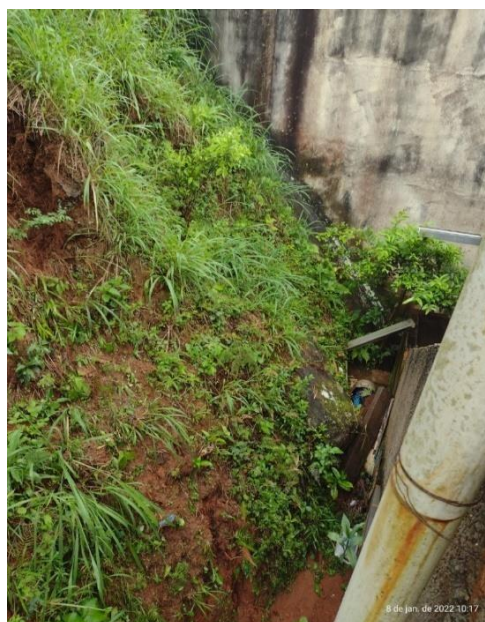
Figura 10: Bloco de rocha inserido no solo coluvionar junto à construção.
