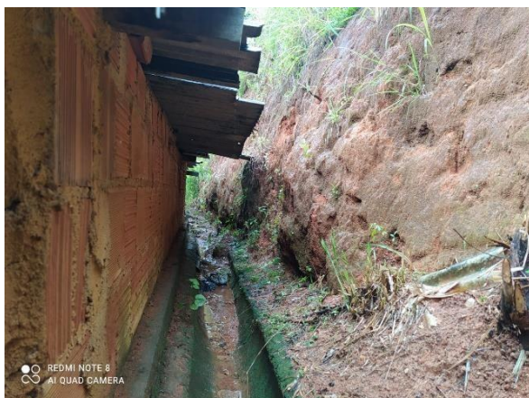
Figura 26: Talude nos fundos da casa nº09.
