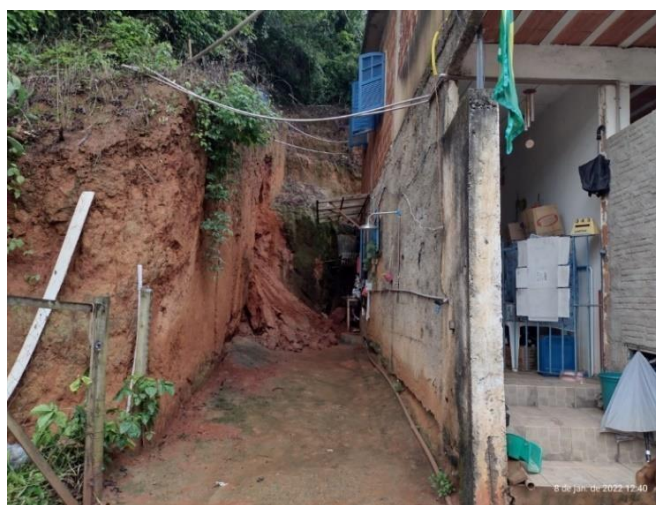
Figura 16: Talude Vertical na lateral da residência, ao fundo material que deslizou.
