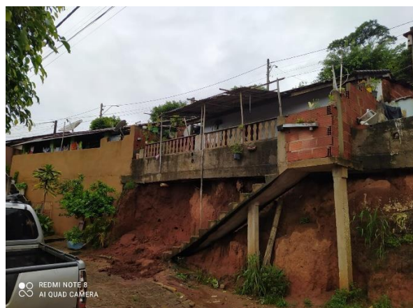
Figura 28: Casa 09, parte frontal tendo a base erodida.
