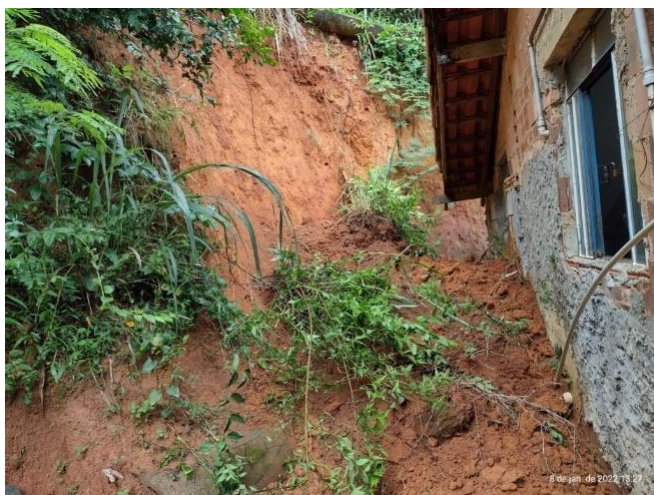
Figura 19: Parte do talude rompido, na parte superior da foto é possível ver a canaleta de cimento.
