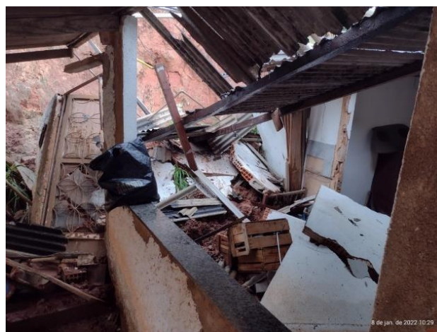
Figura 8: Imóvel destruído por solo e fragmentos rochosos.
