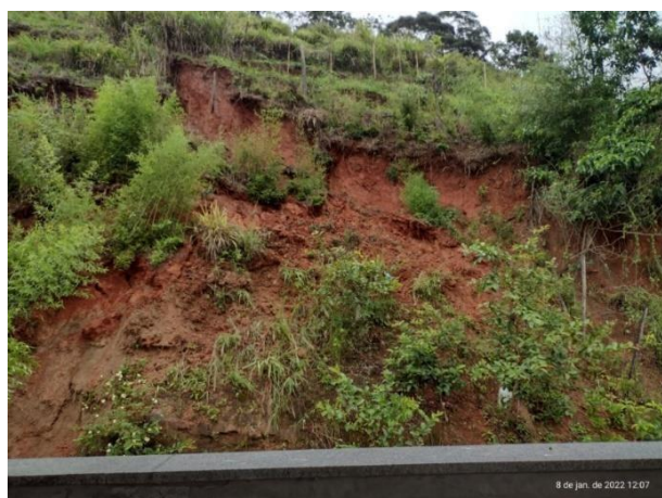
Figura 14: Talude com movimentação, à montante a trilha de boi.
