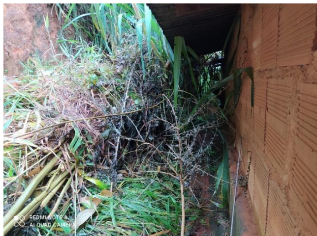
Figura 24: material que escorregou nos fundos da casa.
