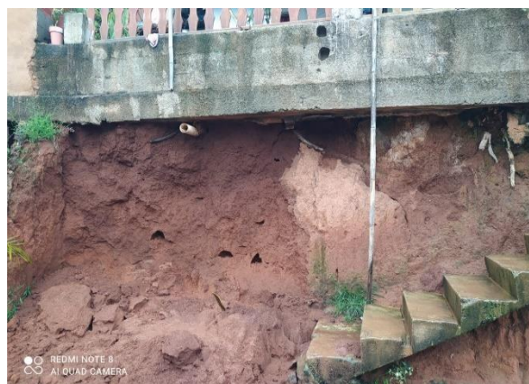
Figura 29: Todo o solo da parte frontal da residência foi erodida.
