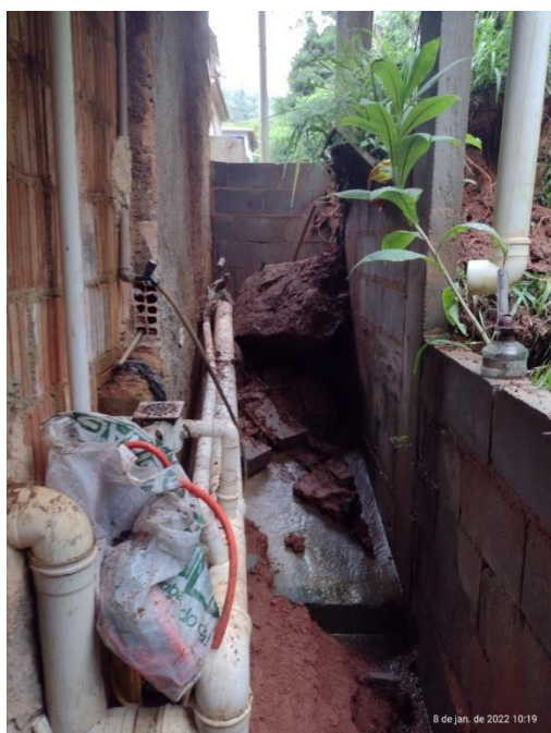
Figura 11: Bloco com mais de 70 cm de eixo maior que atingiu a varanda.
