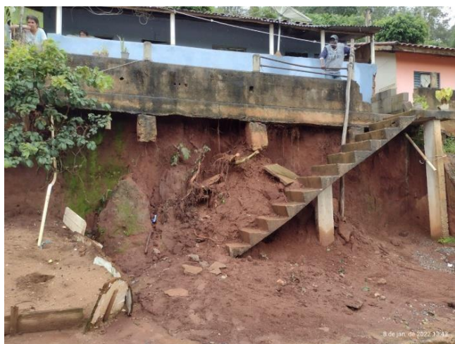
Figura 23: Parte frontal apresenta-se desestruturada.
