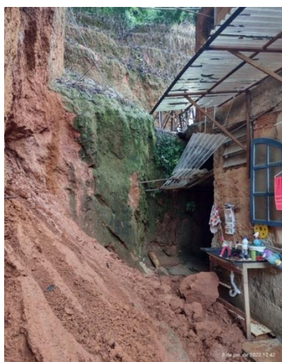
Figura 17: Detalhe do escorregamento.
