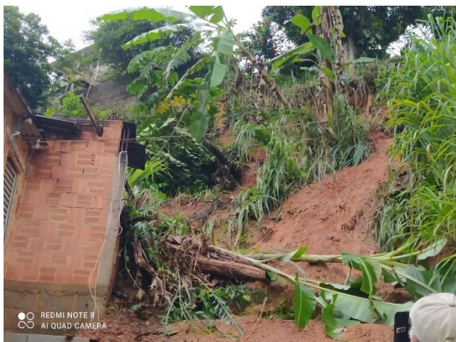
Figura 30: Material coluvionar que atingiu a residência.
