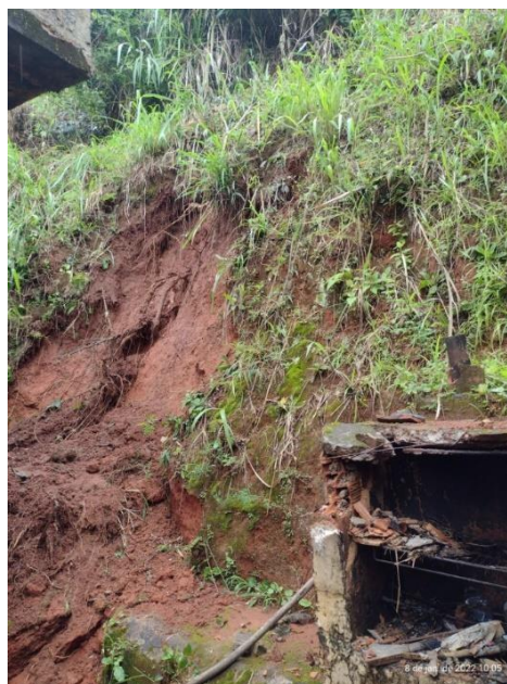
Figura 7: Encosta após deslizamento.
