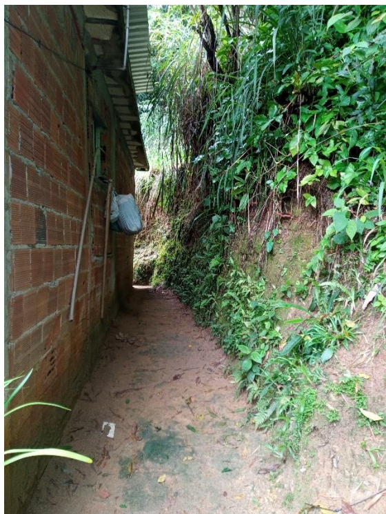
Figura 20: Talude próximo a residência s/n.
