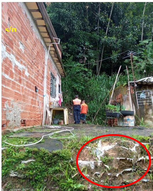
Figura 17: Vista frontal aos fundos das residências s/n e nº 4197. Destaca-se a intervenção rudimentar.
