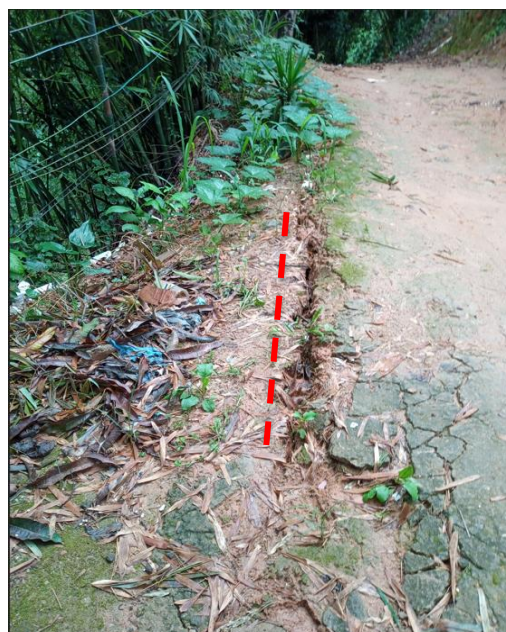
Figura 14: Trincas na servidão.
