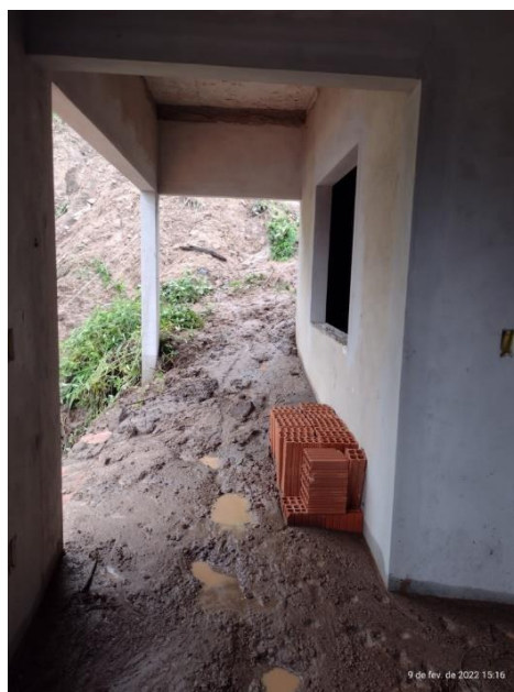
Figura 6: Fluxo de lama e detritos que penetraram no segundo andar.
