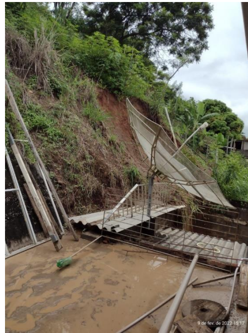
Figura 5: Vista do talude do segundo andar da residência, outro trecho que escorregou.
