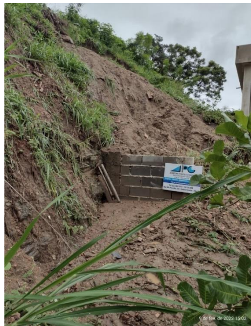
Figura 3: Vista lateral do escorregamento.
