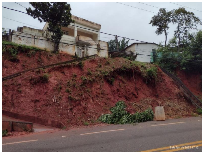
Figura 9: Ação erosiva atuando nos acessos da residência.
