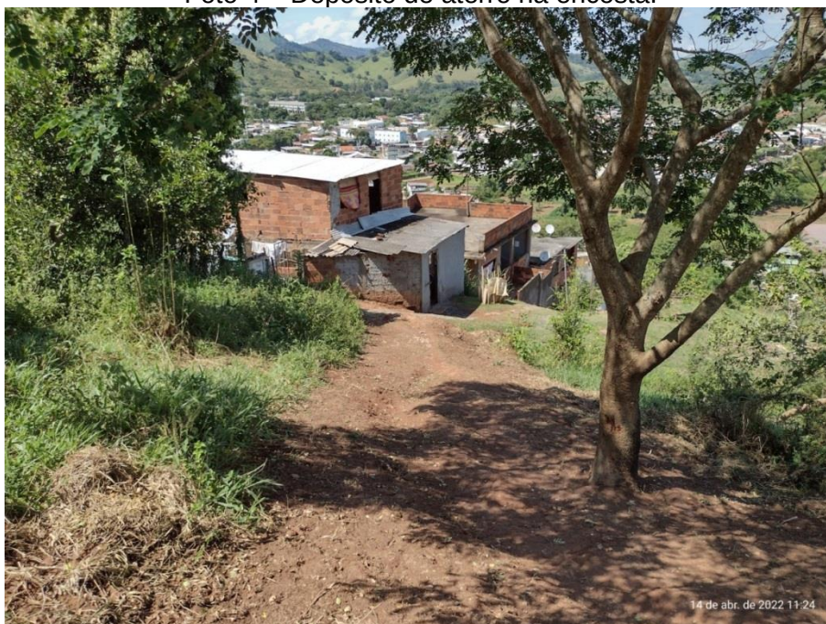
Foto 5- Vias de acesso sem pavimentação, o que possibilita a infiltração de água.
