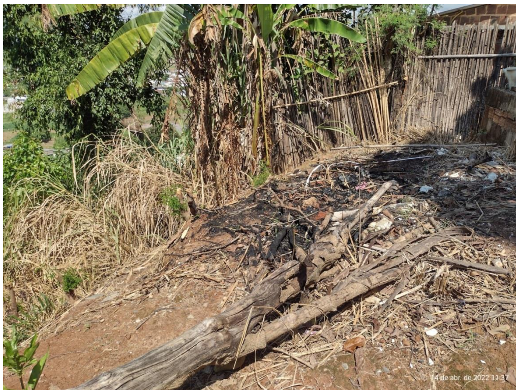
Foto 8 – Trecho à jusante que escorregou em 2012.
