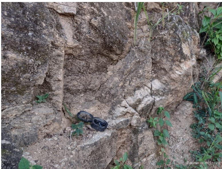
Figura 13 – Outro afloramento com grau de alteração alto, apresentando fraturas
