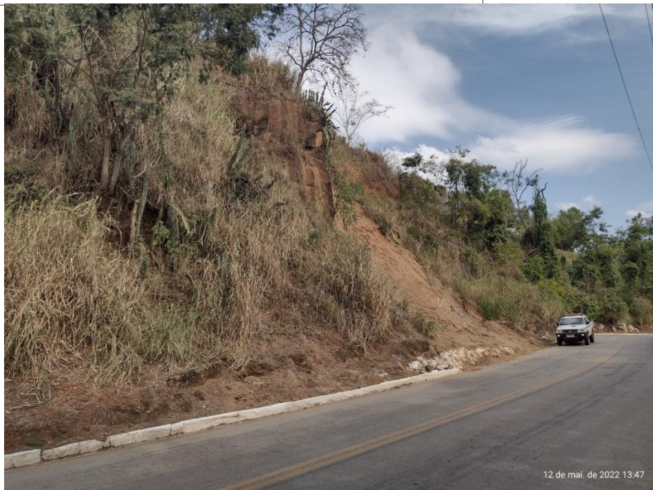
Figura 11- Vista geral da cictriz de escorregamento na estrada Nestor Marins.
