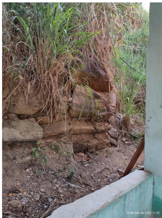
Figura 12 – Afloramento alterado e fraturado com colúvio sobreposto.
