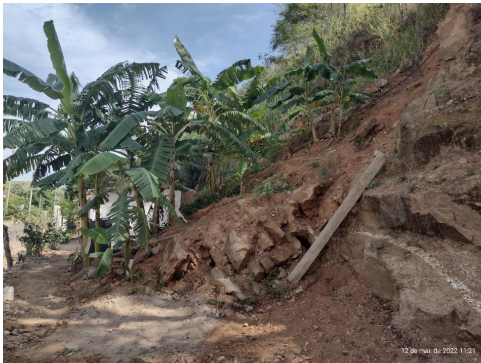
Figura 9 – Cortina atirantada á jusante da BR-101 (km 565).
