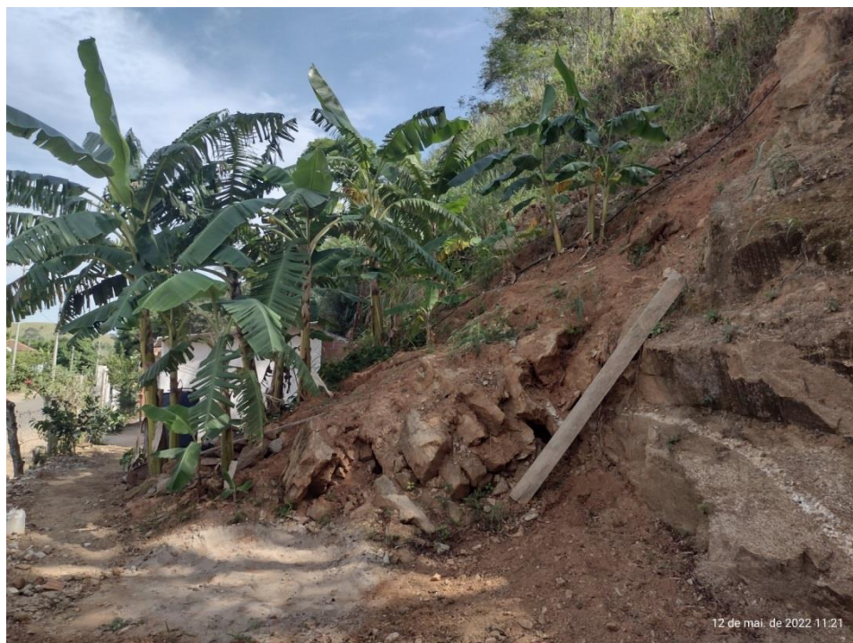
Figura 9 – Escorregamento de colúvio e rocha alterada..
