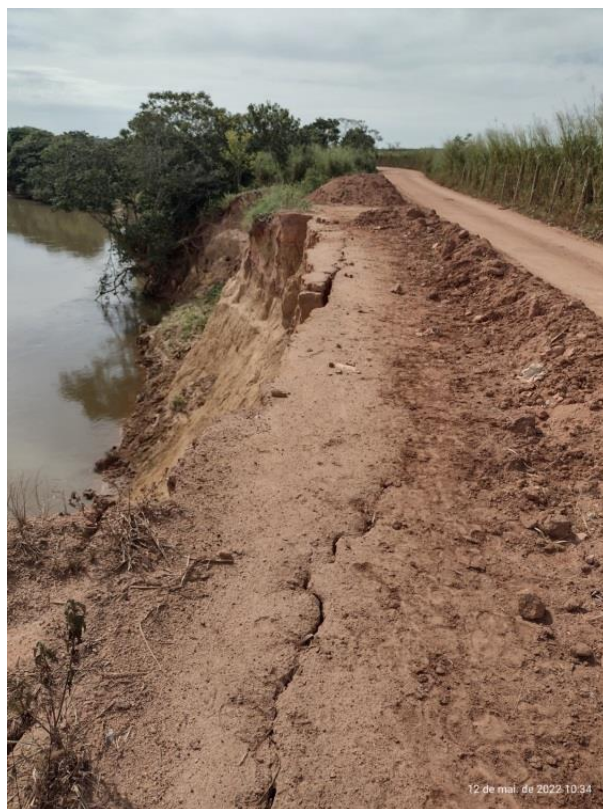
Figura 5 – Trincas na margem, próxima à estrada.
