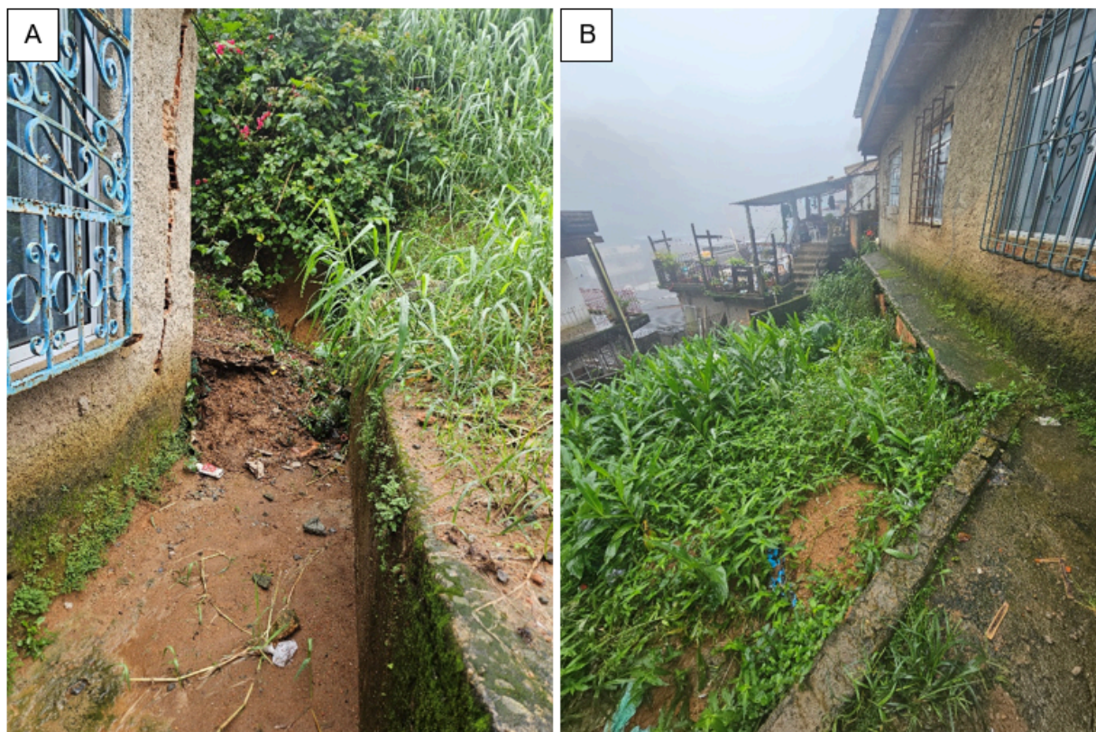
Figura 03: A) Imóvel posicionado à jusante da via, com cerca de 40 cm de material acumulado decorrentes do deslizamento à montante que ultrapassou a mesma; B) Vista frontal do imóvel construído sobre área de aterro, que apresenta processo erosivos no local sendo agravados pelo intenso fluxo superficial causado pelo alto índice pluviométrico.
