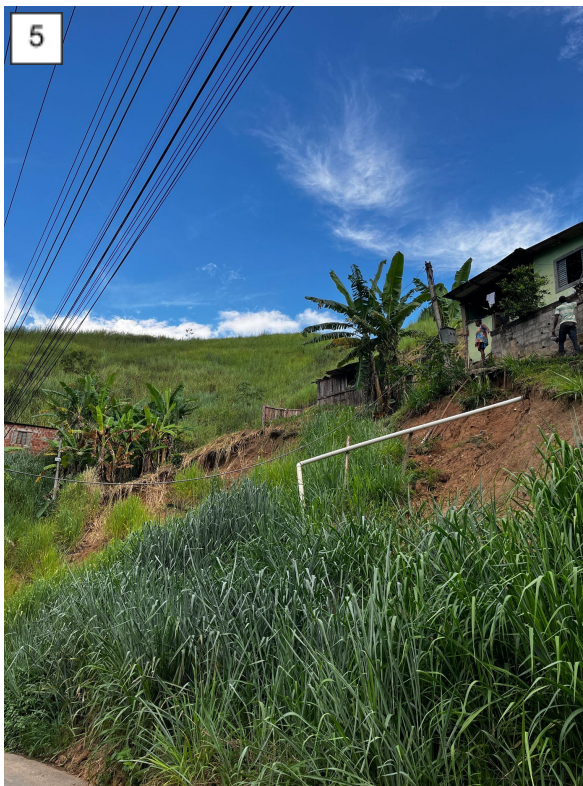
Figura 5: Vista lateral do ponto h), com destaque para bananeiras, cicatriz de deslizamento e um cano de água passando pela encosta.
