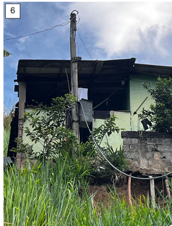
Figura 6: Imagem de detalhe do ponto h), destacando o descalçamento de parte do acesso à moradia, rachadura na fachada e poste inclinado.
