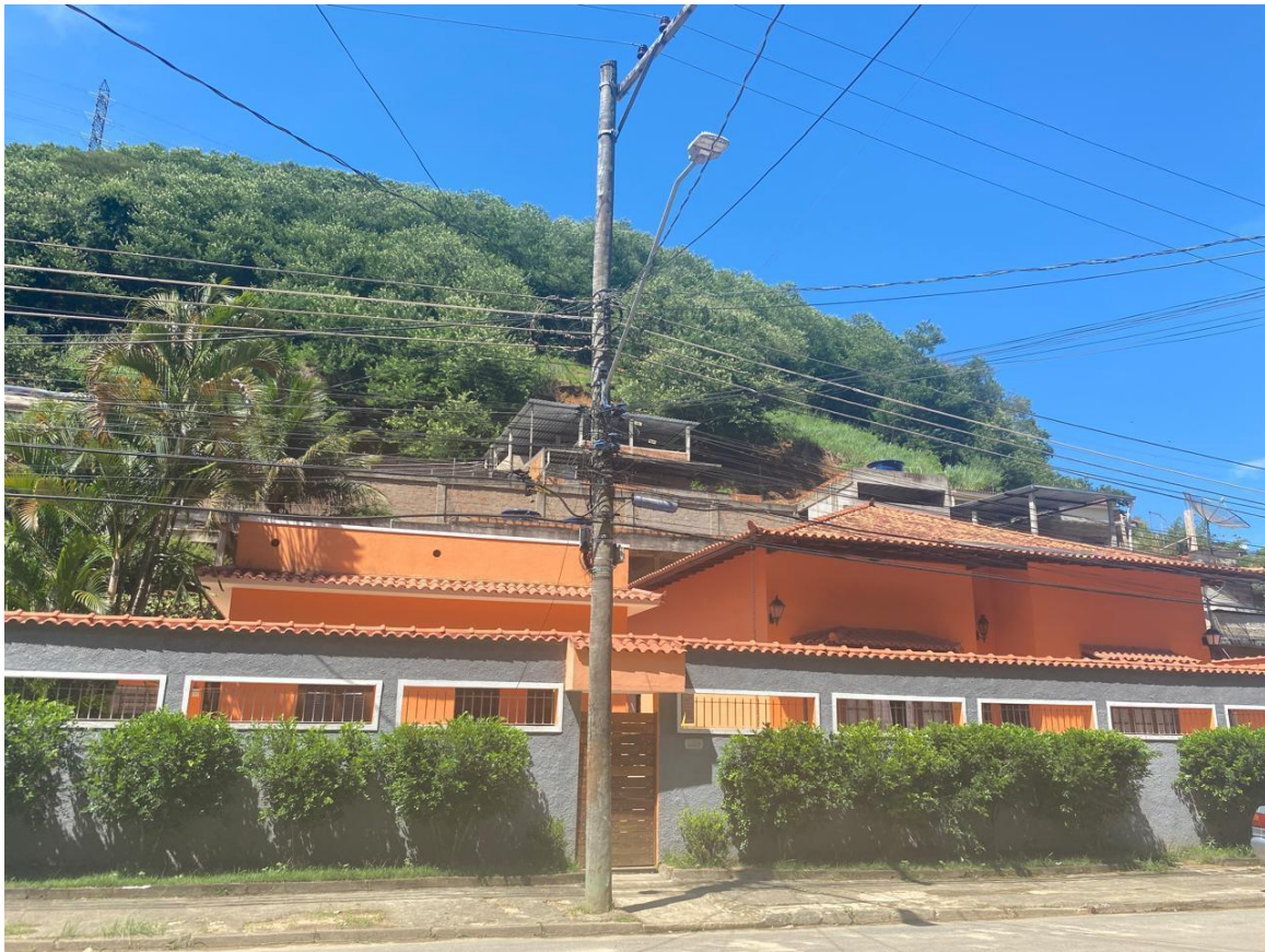
Figura 6: Próximo ao nº 226 da Av. Vera Cruz, olhando em direção a encosta, é possível ver a crista da cicatriz localizada na Rua Santo Antônio, que fica entre a avenida Vera Cruz e a encosta em questão. Essa ocorrência está descrita em f).
