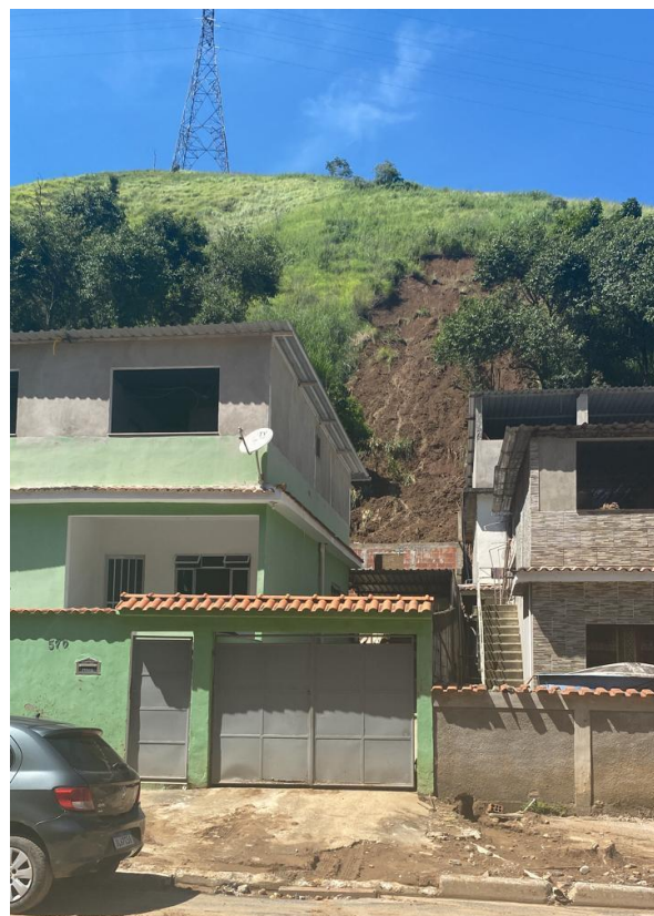
Figura 4: Visada frontal da cicatriz de deslizamento dos fundos da residência nº 570, citada em e).
