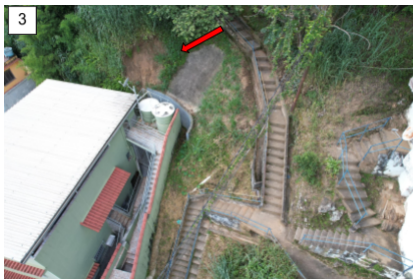
Figura 3: Deslizamento na servidão acima da rua Ovídio de Melo, nos fundos do imóvel nº 162, descrita em c). Ao lado, outra cicatriz recoberta com concreto.
