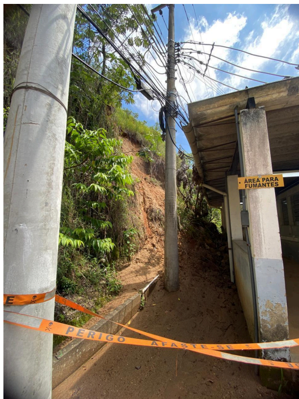
Figura 5: Cicatriz de deslizamento dentro das dependências da Light, Rua Angélica, nº 271, descrita em e). Na base dessa encosta há afloramento de rocha alterada com foliação e fraturas preservadas.
