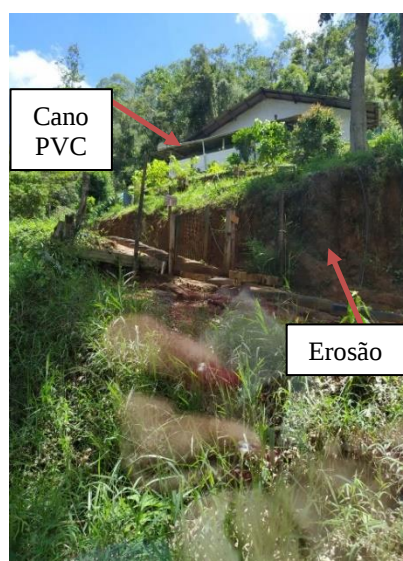
Figuras 64– Ocorrência de erosão e sistema de drenagem pluvial direcionando para encosta.
