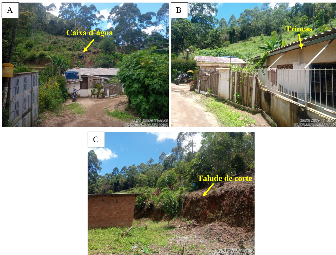
Figura 19 – Condicionantes geológico-geotécnicos observados no primeiro setor do polígono. A – caixa d'água na crista do talude. B – trincas nas residências. C – talude de corte.
