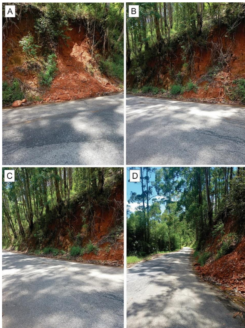
Figura 6 - A e B – fotos com destaque para o escorregamento no talude de corte de estrada. C e D – fotos mostram que as árvores estão inclinadas em direção à rua.
