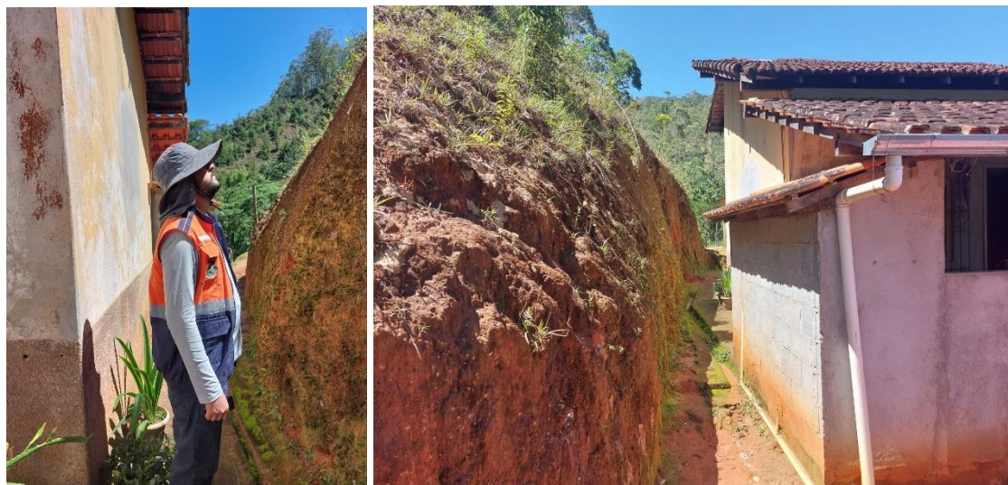
Figuras 68 e 69 - Talude de corte: altura e proximidade com os fundos da residência.
