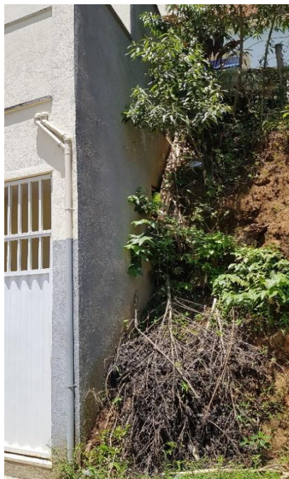
Figura 13 - Lateral da residência danificada conforme descrito no ponto 7.
