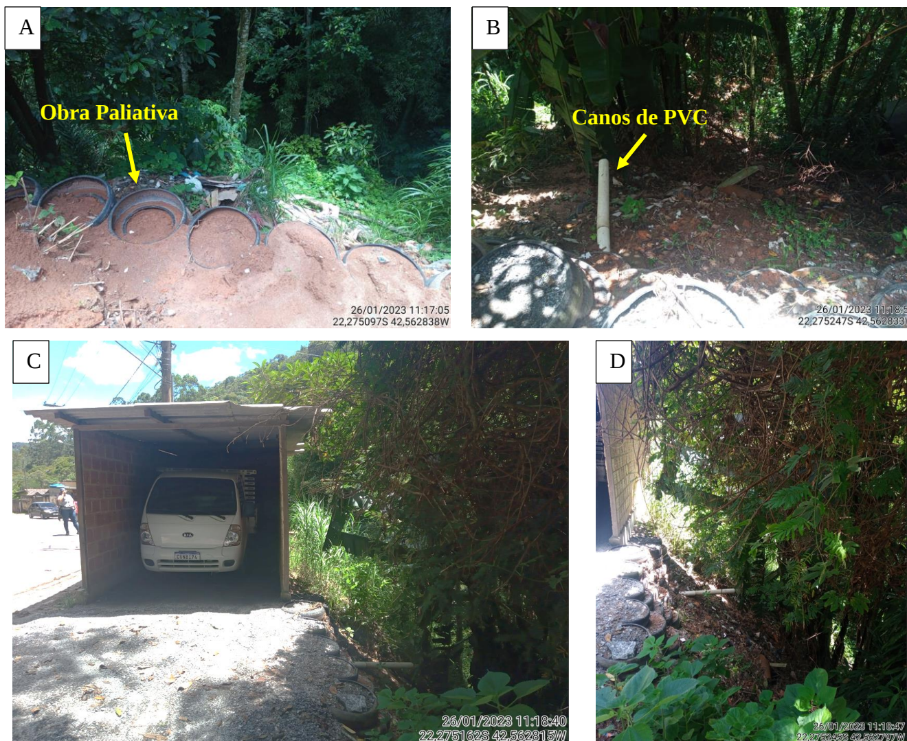
Figura 60 – A - obra de contenção de forma rústica. C - edificação de pequeno porte na crista do talude de corte. B e D – lançamento de água pluvial na encosta.
