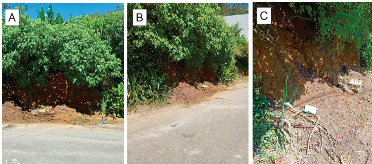
Figura 3 – A, B e C - Imagens do deslizamento no talude na via de acesso a área 4.
