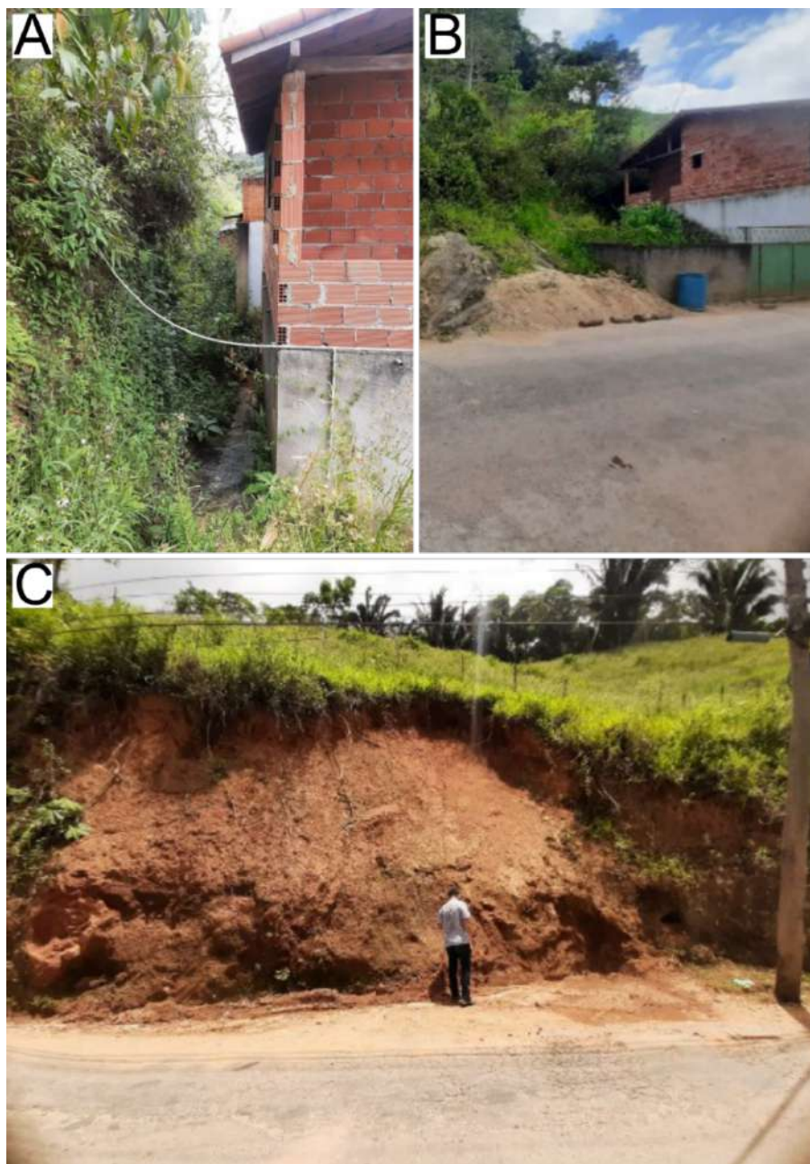
Figura 12: A - Material mobilizado aos fundos da residência 3A. B – Talude de corte no ponto 3A. C - Cicatriz no talude de corte próximo a via principal da região (3B).
