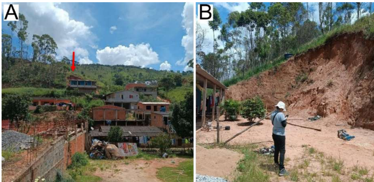
Figura 38: A – Visão frontal da cicatriz; B - Deslizamento em talude de corte a montante da construção
