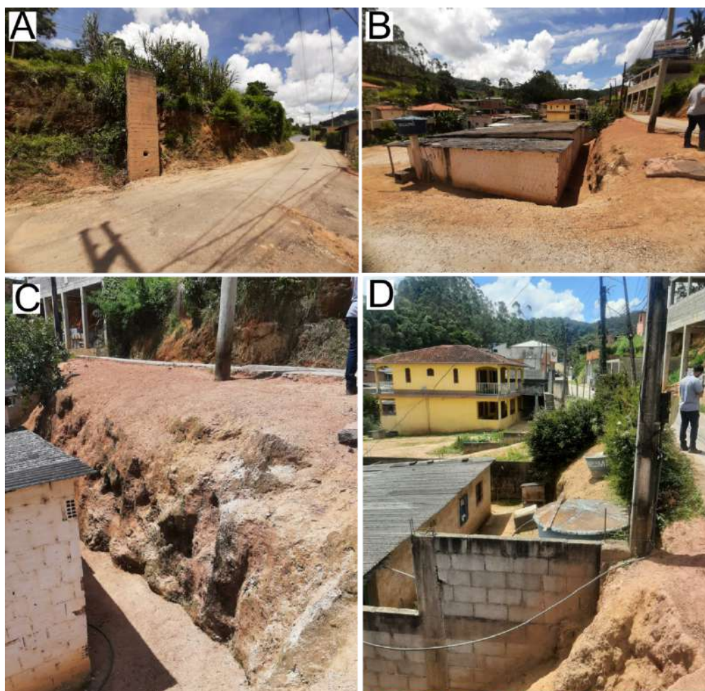
Figura 43: A – Talude de corte a montante da Rua Manoel Silva Pimental. B - Talude de corte com duas moradias a jusante. C – Detalhe do talude de corte. D – Talude de corte com caixa d'água na crista.
