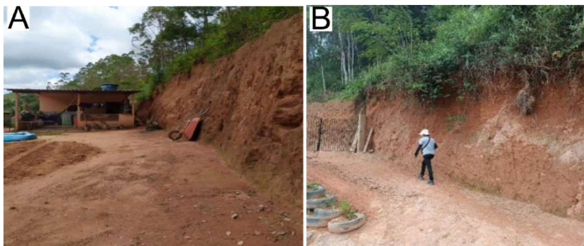
Figura 33 A - Deslizamento em talude de corte, próximo a casa (seta vermelha); B - Altura da encosta e vegetação com raízes expostas
