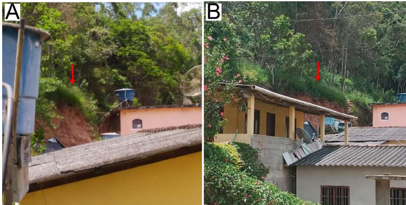
Figura 36: A e B - Cicatrizes de deslizamento em talude de corte.
