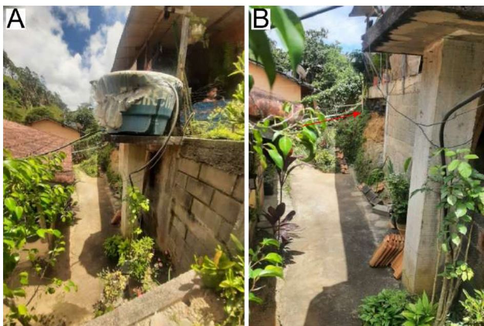
Figura 13: A – Moradia na crista do talude de corte. B – Talude de corte com muro de solo-pneu (seta vermelha) e muro de blocos de concreto.
