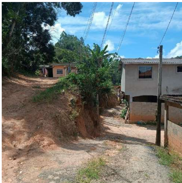
Figura 39: Talude da Rua Dom João
