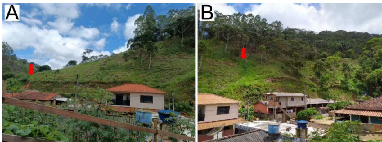
Figura 21: A - Encosta (margem esquerda) da rua Marina Lúcia Pimentel com cicatriz e degraú. B: Drenagem bem marcada.
