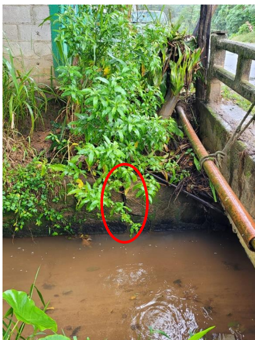
Foto 3: Detalhe da rachadura da base.
