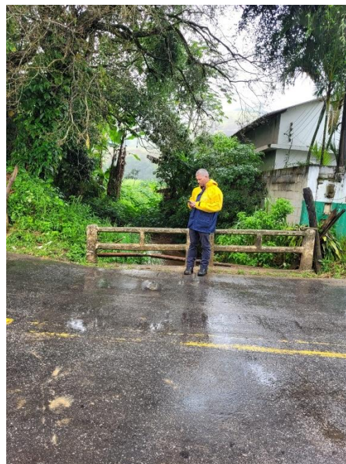
Foto 2: ponte inclinada e pista embarigada.
