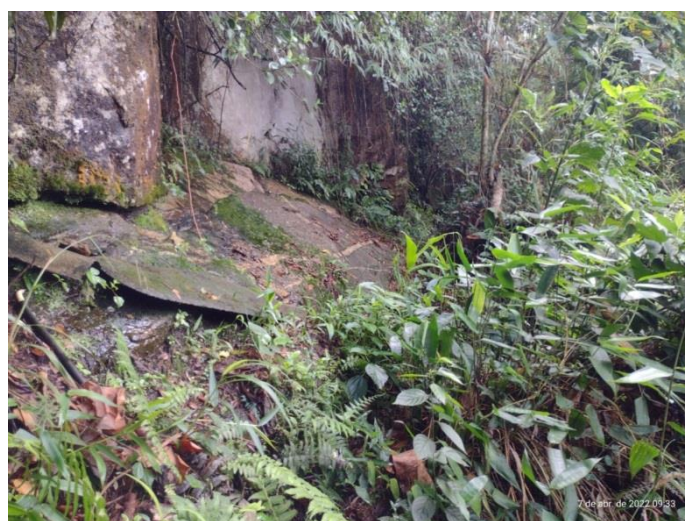
Figura 8: Percolação de água pelas juntas de alívio.
