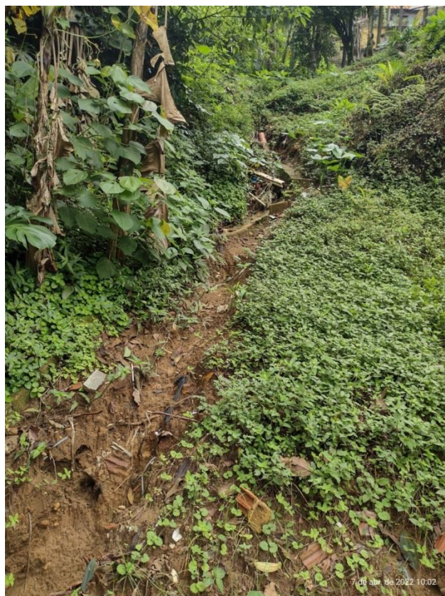
Figura 9: Ação erosiva atuando nos acessos da residência.
