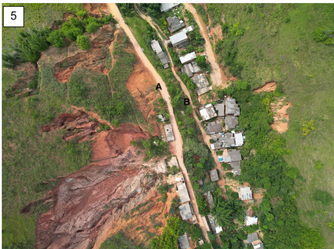
Figura 5: Processos erosivos que estão somando a voçoroca de maior proporção e colocando em risco os imóveis das Ruas Maria de Freitas Barbosa (A) e Rua da Aliança (B).
