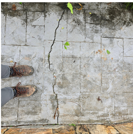
Figura 07: Trinca de abertura milimétrica em pavimento de acesso próximo a área do deslizamento ocorrido.
