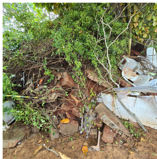
Figura 02: Desabamento de estrutura do Quiosque do Baixinho associado ao deslizamento deflagrado em talude a montante.
