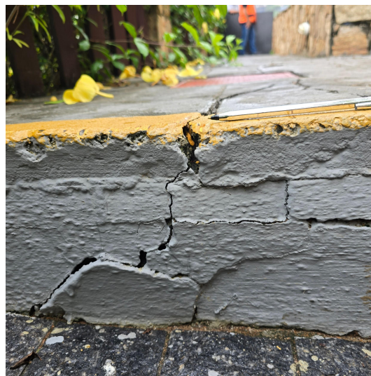
Figura 09b: Detalhe da trinca no espelho da escada de acesso do Bloco 6.
