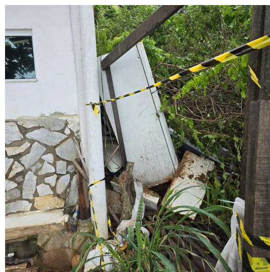
Figura 04: Parte do material desabado escorado em parede lateral do Quiosque Caiaque.
