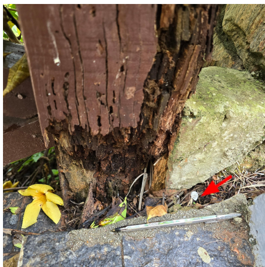
Figura 10: Abertura centimétrica em parte lateral da estrutura da escada do Bloco 6.
