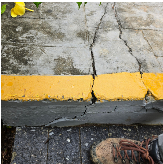
Figura 09a: Fissuras e trincas de aberturas milimétricas em pavimento, afetando degrau da escada de acesso do Bloco 6.
