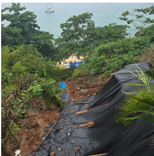
Figura 01: Ocorrência de deslizamento planar na Rua João Fernandes.
