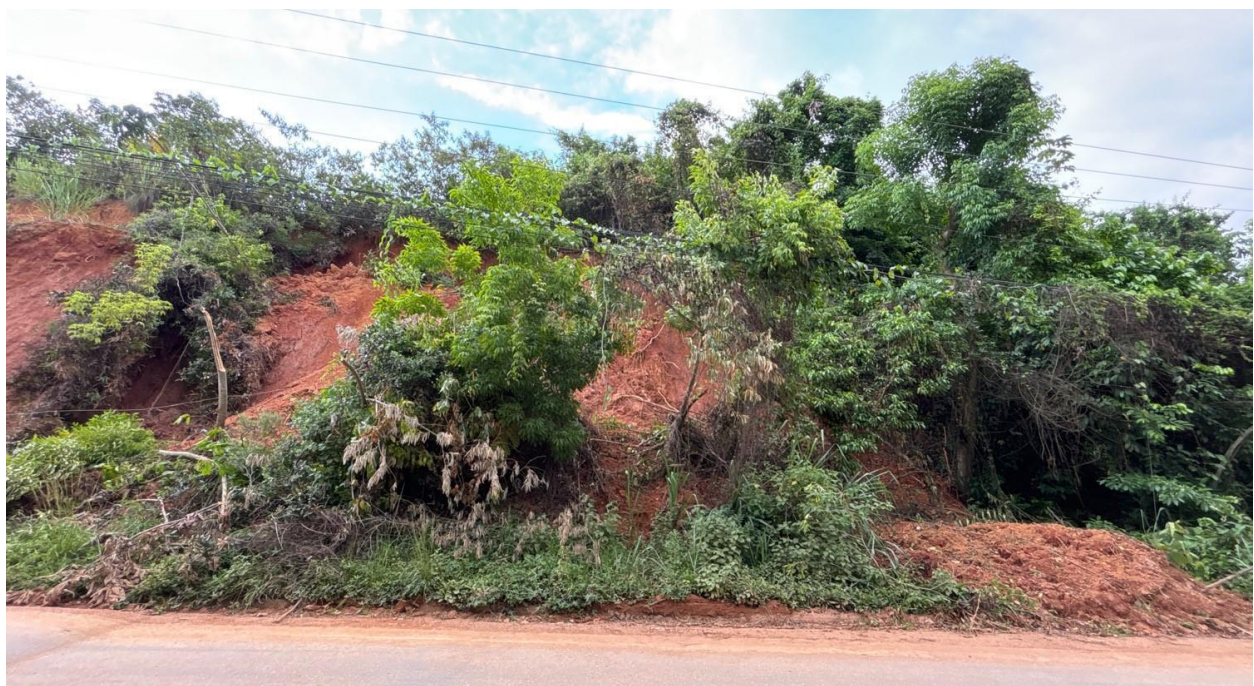
Figura 2. Deslizamento planar no corte de estrada, que causou o fechamento temporário da via.
