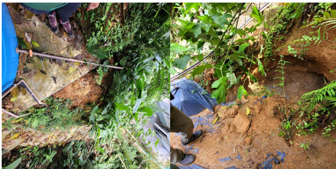
Figura (10) extravasor e tubulação caixa d'água; (11) porção de solo exposto e saturado.
