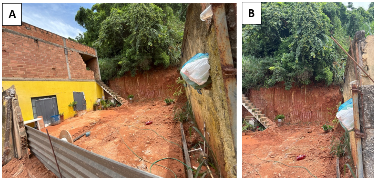
Figura 04: A) Imóvel LT37 QD9, sem habitantes no momento, demonstrando talude verticalizado, com sinais de deslizamento, feições erosivas e raízes aparentes. É possível observar inclinação do muro limítrofe do imóvel com risco de queda tendendo para o pátio do mesmo; B) Área de maior acúmulo de material depositada aos fundos do terreno, se estendendo ao longo do muro limítrofe.
