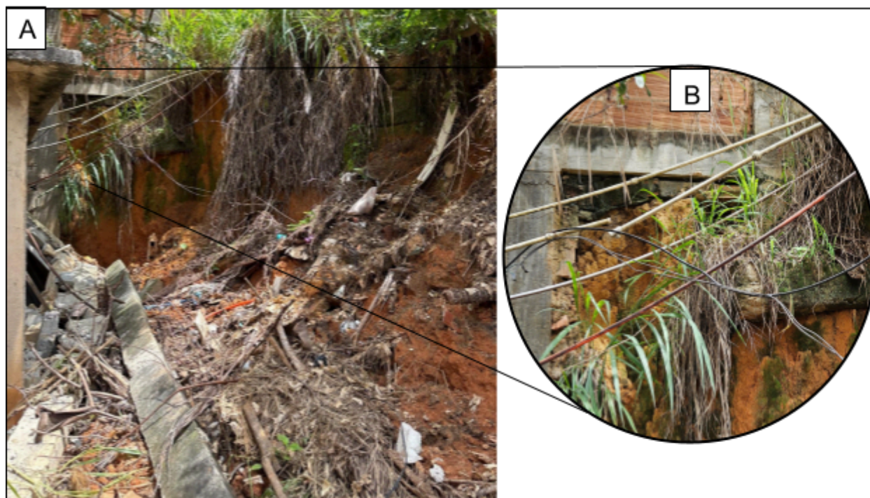
Figura 2. (A) Vista da lateral esquerda, com partes do muro dos fundos da casa que colapsou. (B) Ênfase na mobilização de material da fundação da casa vizinha, e tubulações de água rompidas pelo evento.
