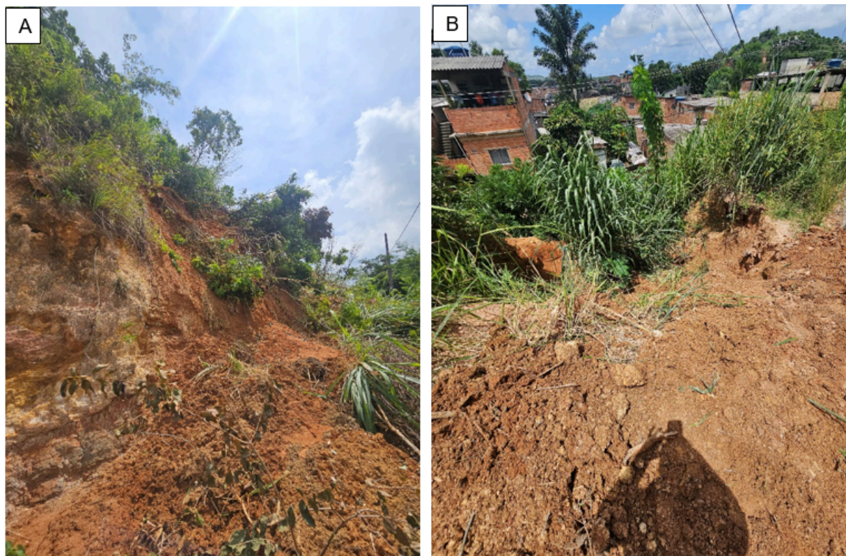
Figura 01: A) Cicatriz de deslizamento planar no contato solo-rocha alterada à montante da Rua do Farol, com intensa mobilização de material argilo-arenoso e elementos arbóreos; B) Cicatriz de deslizamento à jusante da Rua do Farol, com material mobilizado sendo depositado aos fundos dos imóveis localizados na Rua Alcântara.
