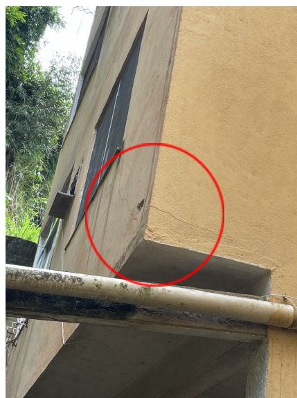
Figura 6: Parte do material mobilizado atingiu o prédio.
