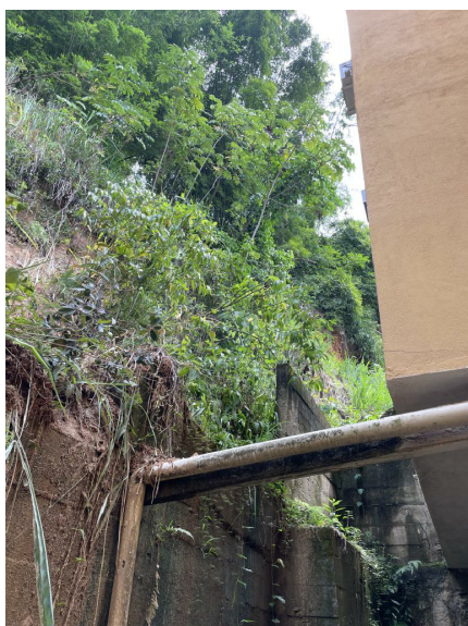
Figura 5: O material mobilizado atingiu os canos expostos, mas não constou avaria.
