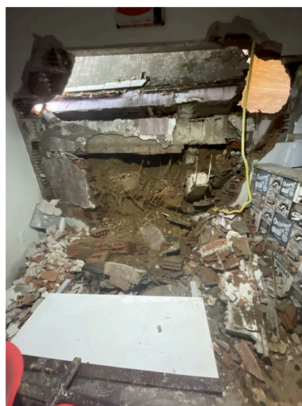
Figura 6: Cômodo da residência atingida parcialmente pelo movimento gravitacional de massa.
