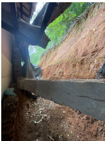
Figura 3: Deslizamento planar que atingiu parcialmente 1 cômodo da residência de nº 808.
