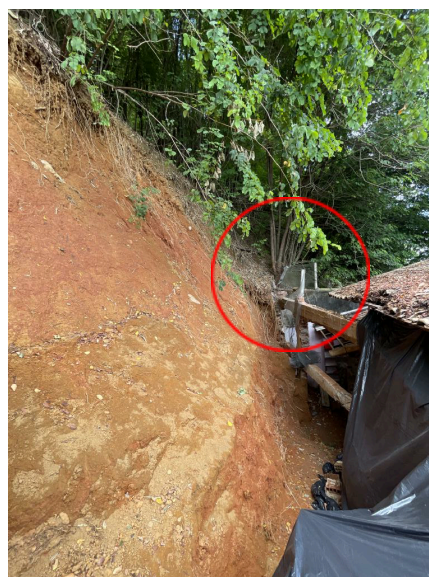
Figura 4: O deslizamento derrubou um muro de alvenaria que servia de contenção entre a casa e o talude. Destaque para a árvore com iminência de queda (círculo).
