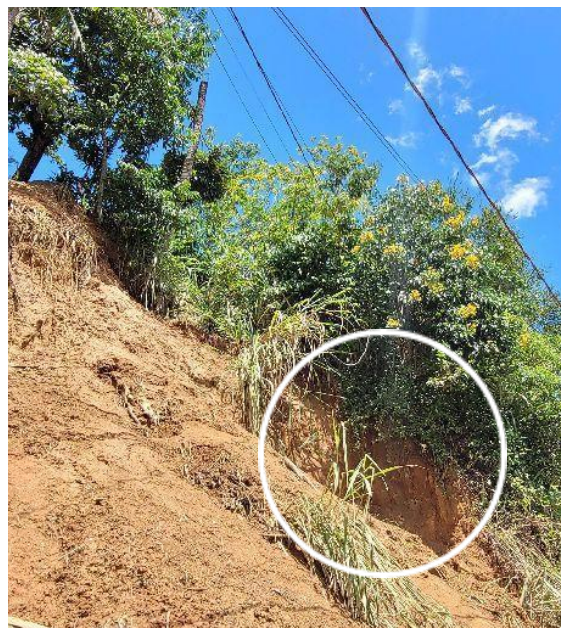
Figura 03: Deslizamento a jusante de C1 e C2, com destaque para vazios no solo (círculo branco), podendo causar descalçamento sobre ele (árvores e solo).
