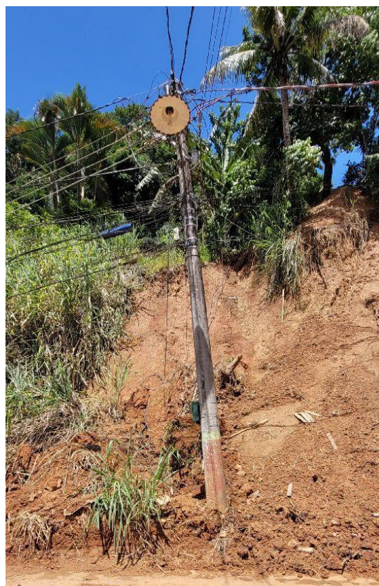
Figura 05: Deslizamento a jusante de C1 e C2, vista frontal do poste inclinado.
