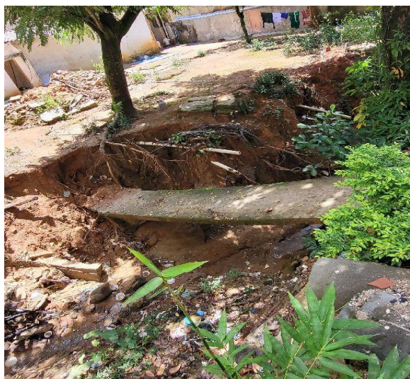
Figura 02: Ocorrência de deslizamento com desabamento de ponte de acesso.
