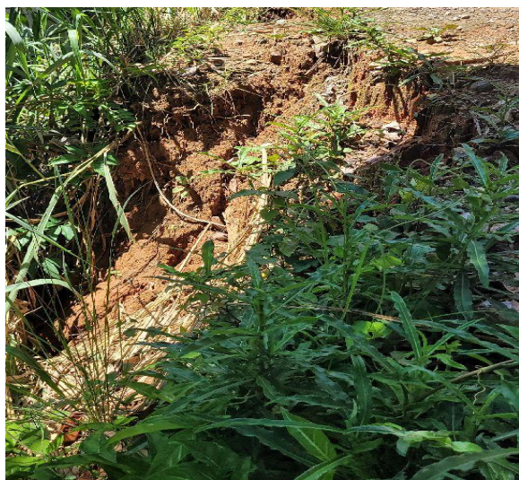
Figura 04: Deslizamento com material mobilizado depositando-se dentro do canal.
