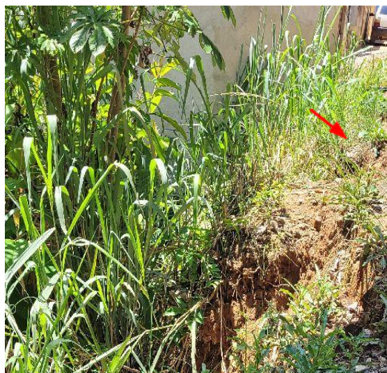
Figura 05: Detalhe para descalçamento incipiente de via de acesso.
