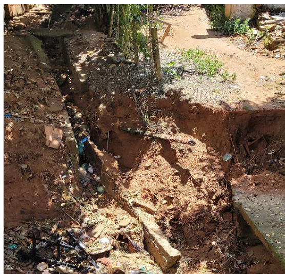
Figura 03: Deslizamento ocasionando rompimento de estrutura de microdrenagem.
