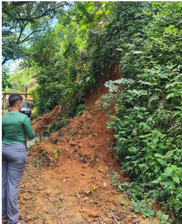
Figura 02: Ocorrência de deslizamento planar de pequeno porte no acesso ao imóvel, a montante da Rua Antúrios.
