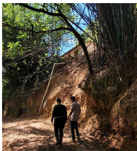
Figura 05: Ocorrência a jusante do imóvel, muito próximo de sua base; tubulação exposta; solo em negativo; raízes e rizomas de bambuzal expostos.
