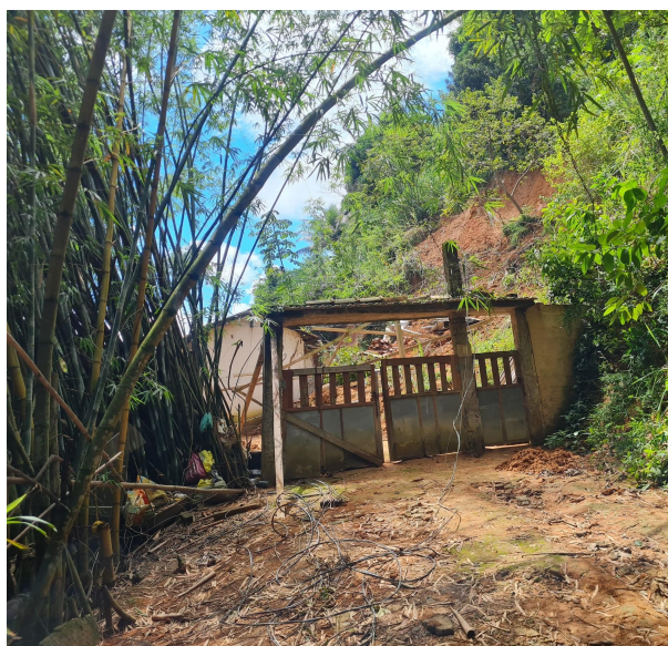
Figura 04: Ocorrência nos fundos do imóvel, talude a montante, com atingimento e destruição parcial de edificação.
