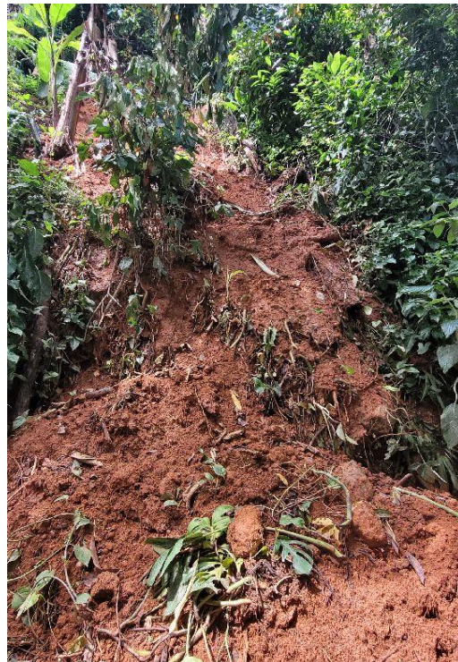
Figura 03: Ocorrência do segundo deslizamento planar de pequeno porte no acesso ao imóvel, a montante da Rua Antúrios.
