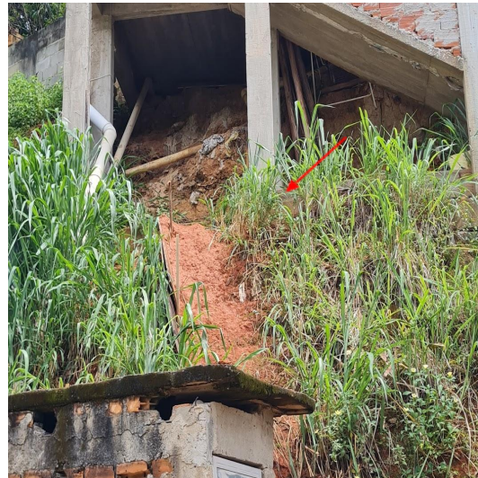
Figura 03: Ponto de ruptura de deslizamento próximo a um dos pilares de estrutura da edificação nº 120.
