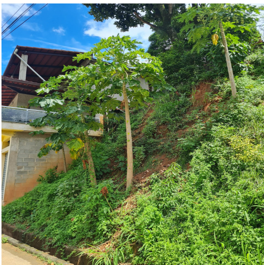
Figura 04: Feições erosivas ativas no talude, a sul do nº 120.
