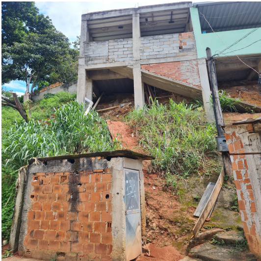
Figura 02: Ocorrência de deslizamento planar na Rua das Hortências, nº 120.
