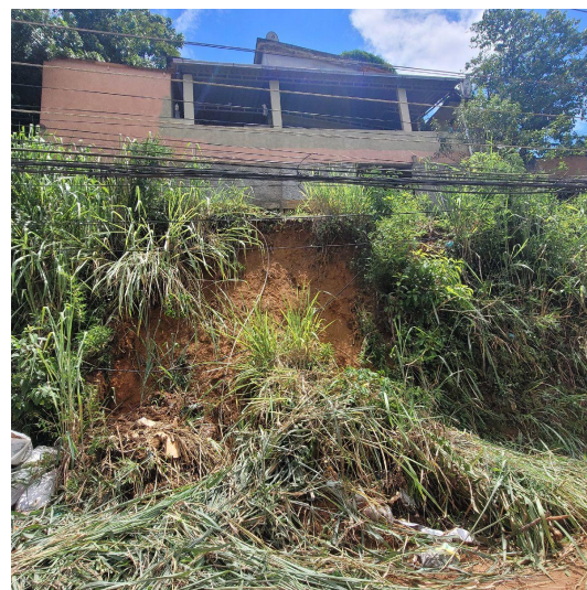
Figura 05: Ocorrência 2, deslizamento planar a montante da Rua das Hortências.
