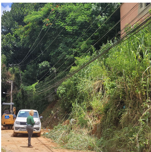
Figura 06: Deslizamento ocasionou obstrução parcial de parte da estrutura de microdrenagem da rua.
