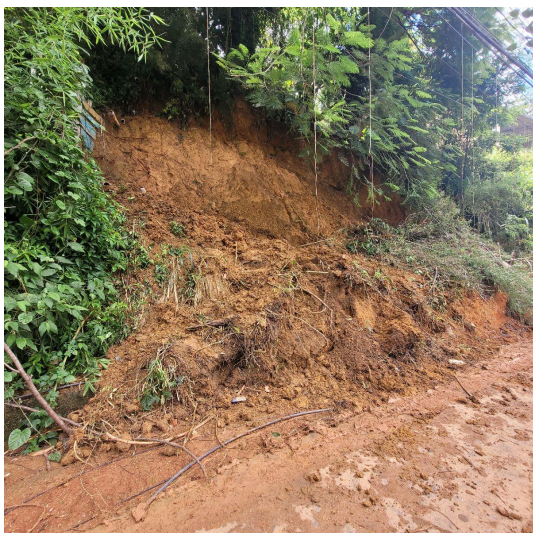
Figura 02: Ocorrência 1, deslizamento planar a montante da Rua das Hortências, nº 224.
