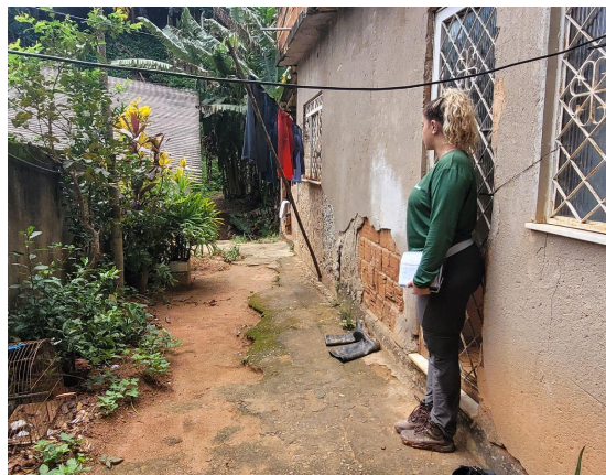
Figura 05: Descalçamento do piso lateral da casa C1.
