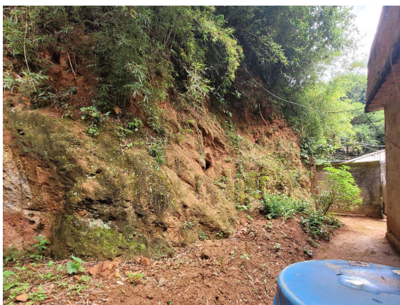
Figura 08: Feições erosivas do talude.
