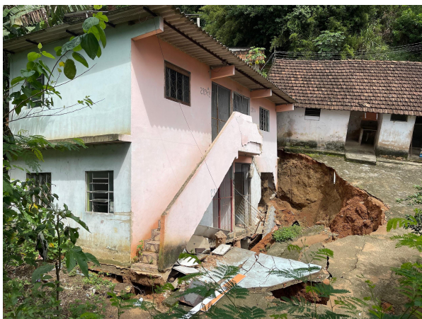
Figura 02: Ocorrência A, solapamento às margens do rio, imóveis do casa tombada e casa n°5 ao fundo.
