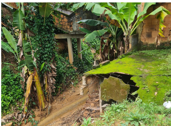
Figura 06: Quebra parcial do piso de acesso a C1.
