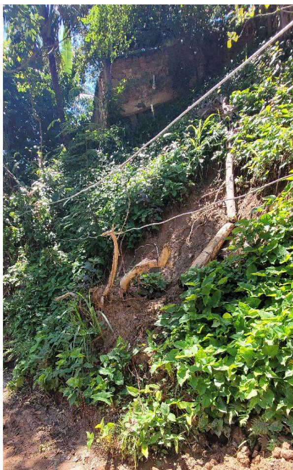
Figura 04: Deslizamento expondo a base do muro.
