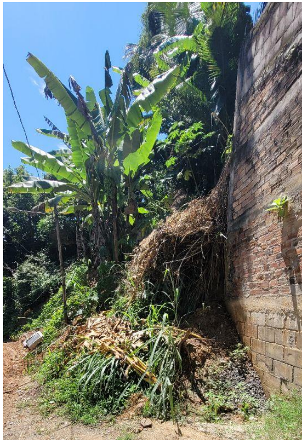
Figura 02: Alcance do deslizamento planar na lateral do muro do imóvel C2.
