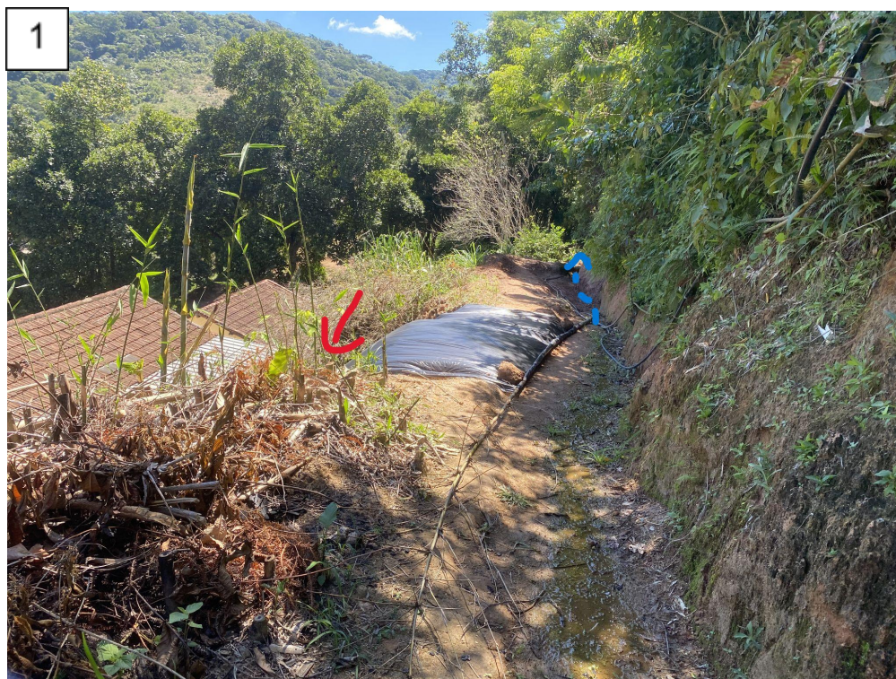
Figura 1: Deslizamento planar em talude de corte, a menos de 1,5m da casa na rua Neivaldo, número 476. No local ocorre uma mina d'água com fluxo constante.
