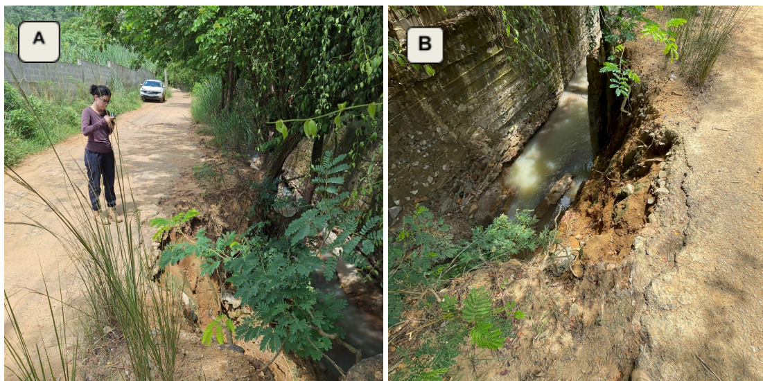
Figuras A e B: Erosão na margem esquerda do canal que está afetando parcialmente a via de acesso dos moradores.
