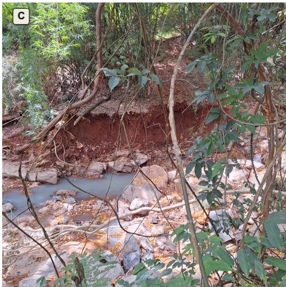
Figura C: Parte da margem a montante da fábrica da Embelleze erodida pela força da enxurrada do dia 21 de fevereiro.
