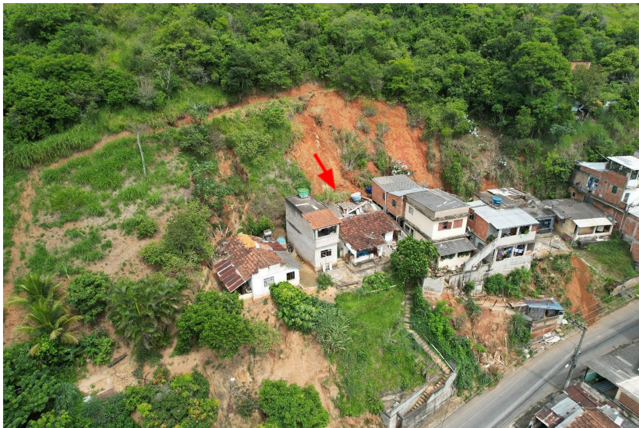
Figura 1: Cicatrizes de deslizamentos na rua Tereza Jesus Vasconcelos, nº 41. Destaca-se as construções próximas aos taludes de corte com distâncias nulas. A ocorrência de desmoronamento está indicada pela seta.
