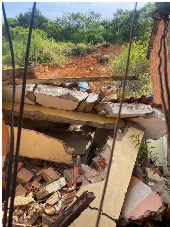
Figura 2: Imagem mostrando escombros do desmoronamento de 2 pavimentos dos fundos da casa. Observar no topo da imagem a crista da cicatriz de deslizamento.
