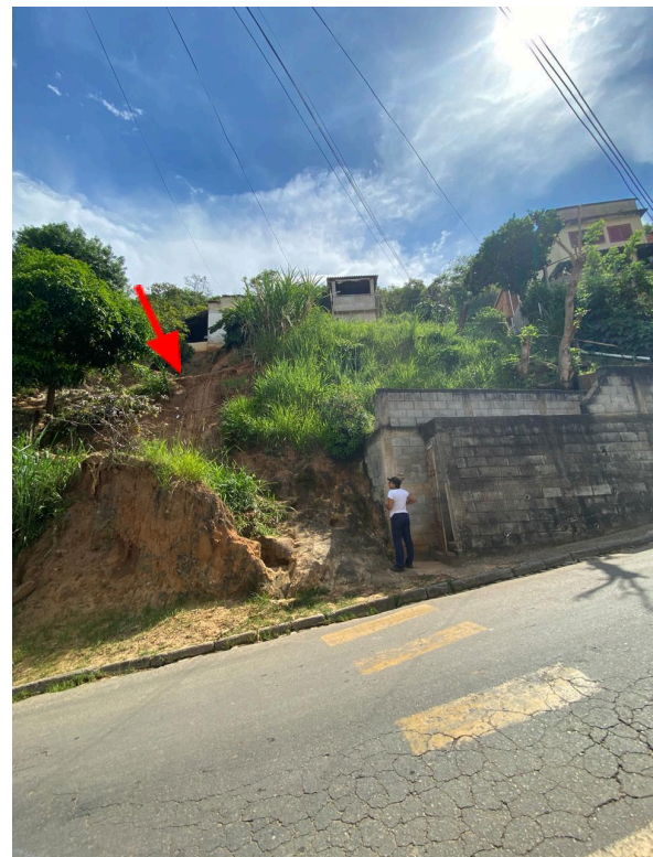
Figura 3: Visada frontal das casas do nº 41, rua Tereza Jesus Vasconcelos. Observar a presença de cicatrizes de deslizamento também a jusante das casas.
