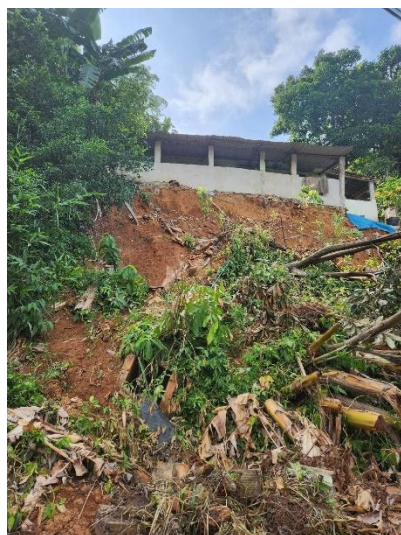
Figura 1: Ocorrência A, deslizamento a jusante da Casa 1 do N° 85
