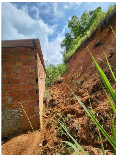
Figura 3: Ocorrência B, deslizamento que atingiu a Casa 2 do N° 85
