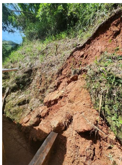
Figura 5: Ocorrência C, deslizamento de solo e blocos de rocha alterada.
