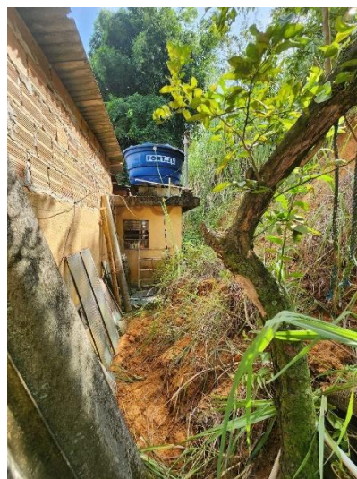
Figura 2: Deslizamento em talude de corte aos fundos da Casa 1 do N° 85
