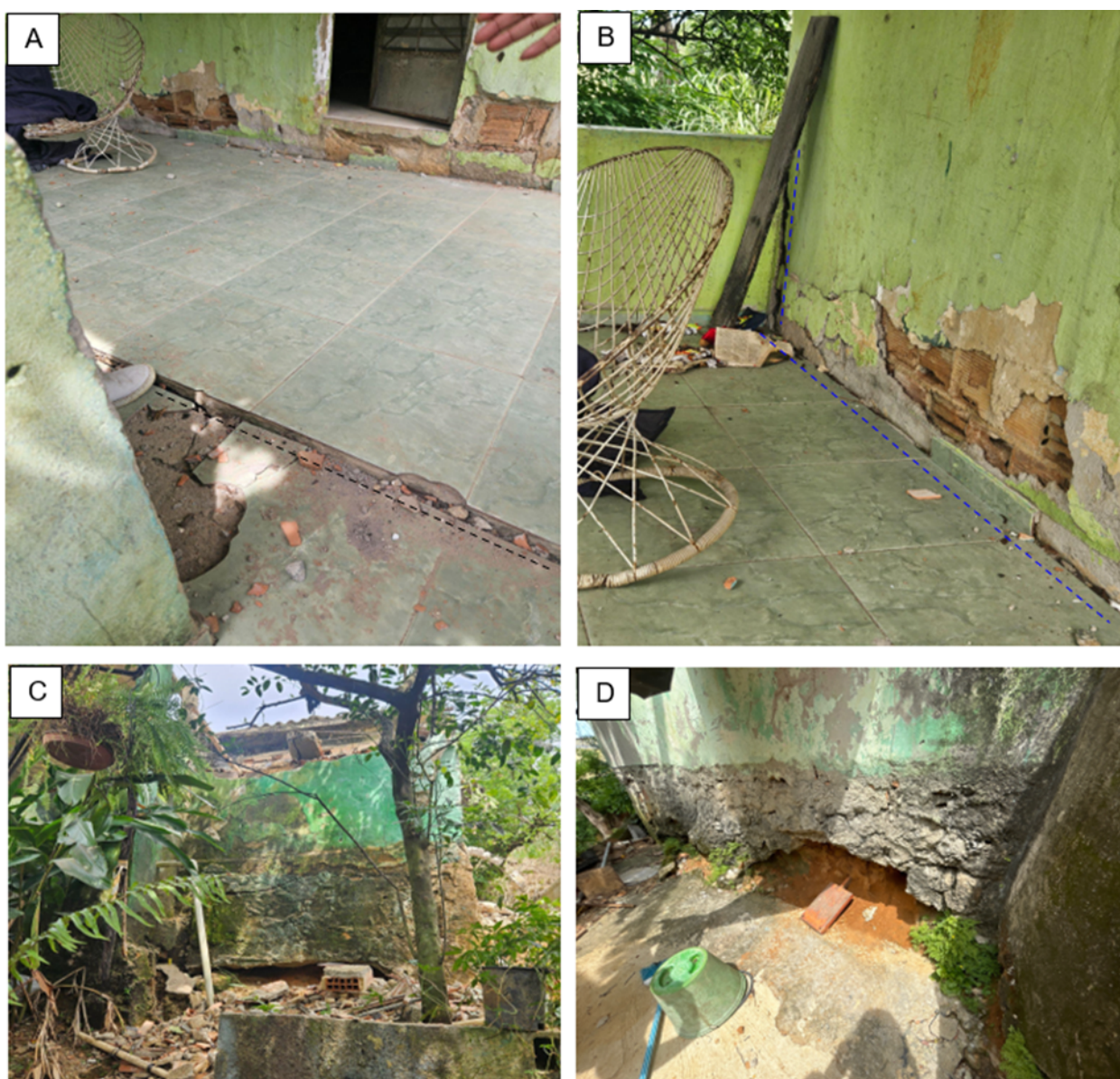
Figura 02: A) Área da varanda do imóvel 4004 com afundamento próximo a entrada de acesso (linha pontilhada preta); B) Visada lateral da varanda do imóvel, onde foi identificado separação da varanda da estruturada da edificação (linha pontilhada azul); C) Perda de material sob banheiro demolido e; D) Perda de material sob estrutura da residência, previamente escondida por lona.
