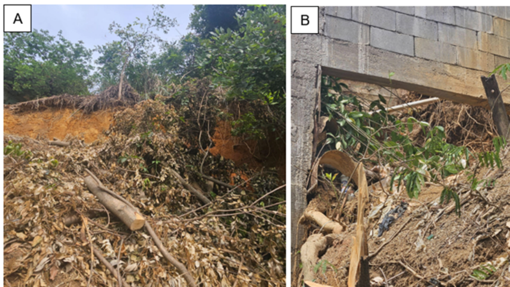
Figura 01: A) Cicatriz de deslizamento planar com material mobilizado composto por camada de solo argilo-arenoso e elementos arbóreos; B) Visada lateral da cicatriz de deslizamento demonstrando colapso parcial de muro limítrofe e perda de material sob área do banheiro da edificação dos fundos do imóvel nº 4004.
