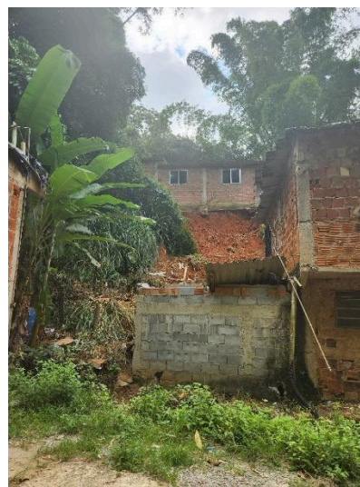
Figura 4: Ocorrência C, deslizamento que atingiu a casa de nº 218 e casa não identificada a montante do movimento
