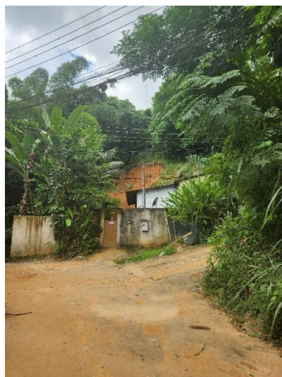
Figura 3: Visada mais ampla do deslizamento aos fundos da casa 219
